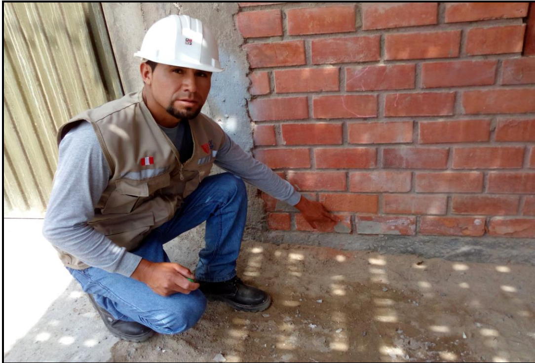
Figura N° 15: Se aprecia la fachada afectada por patologías de humedad, eflorescencia y erosión física del zócalo, columna y muro de la vivienda
