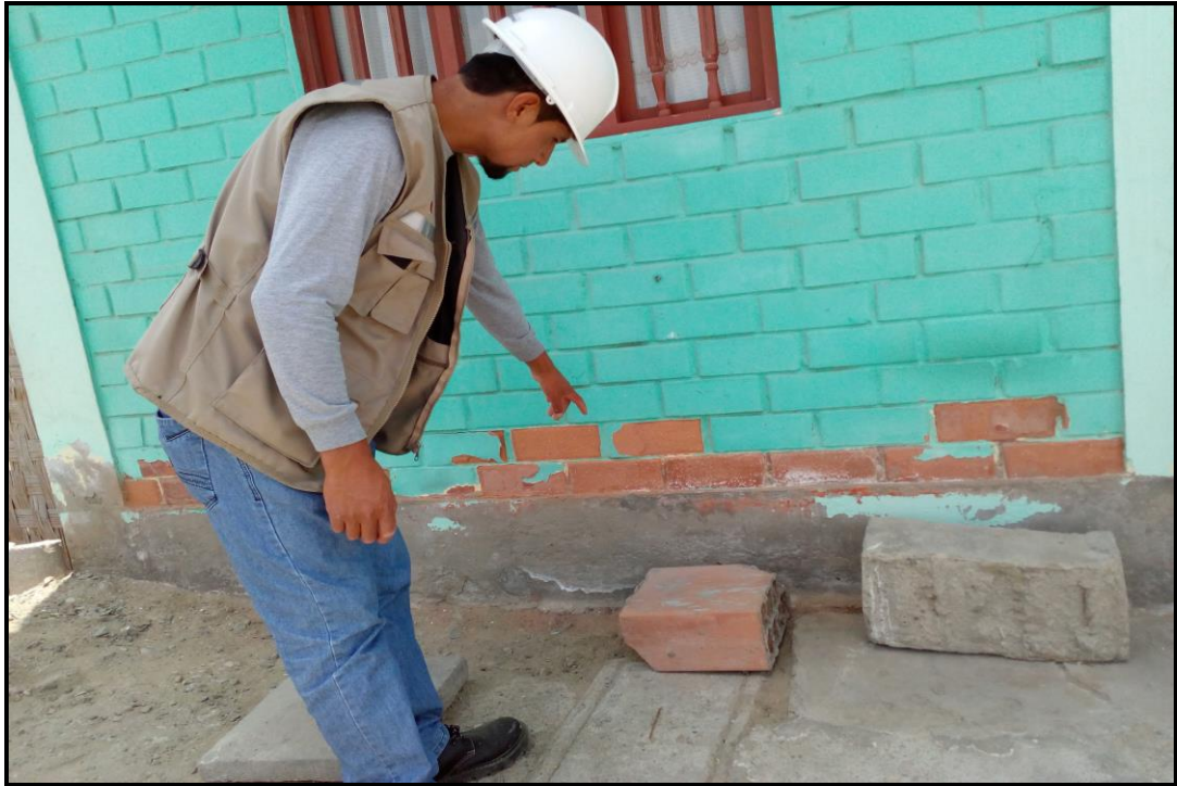
Figura N° 13: Se aprecia la fachada con recubrimiento pintura al agua afectada por patologías de humedad, eflorescencia y erosión química del zócalo y muro de la vivienda
