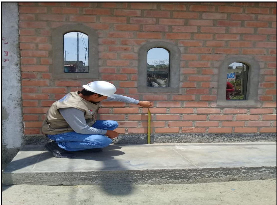
Figura N° 16: Se aprecia la fachada afectada por patologías de humedad y erosión química del sobre cimiento zócalo de la vivienda
