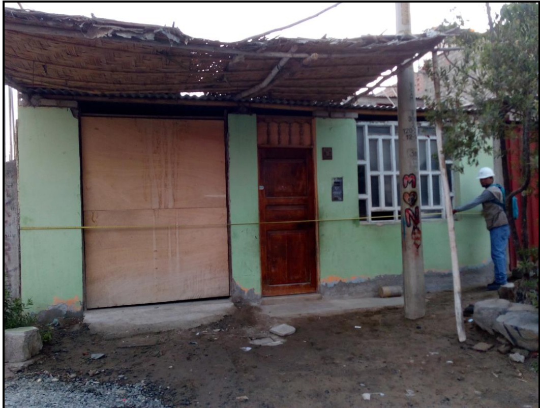
Figura N° 01: Se aprecia la medición de la fachada, para determinar el porcentaje de patología afectada, en el zócalo y muro.
