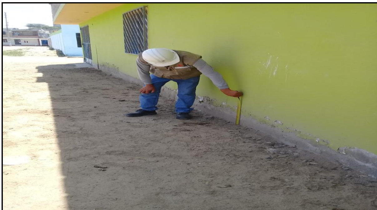
Figura N° 17: Se aprecia la fachada afectada por patologías de humedad, eflorescencia del zócalo, muro de la vivienda
