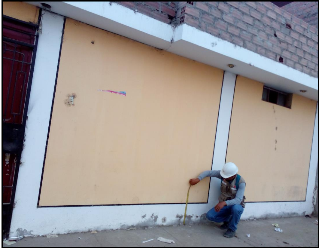
Figura N° 03: Se aprecia la fachada, afectada por erosión física, humedad en el zócalo
