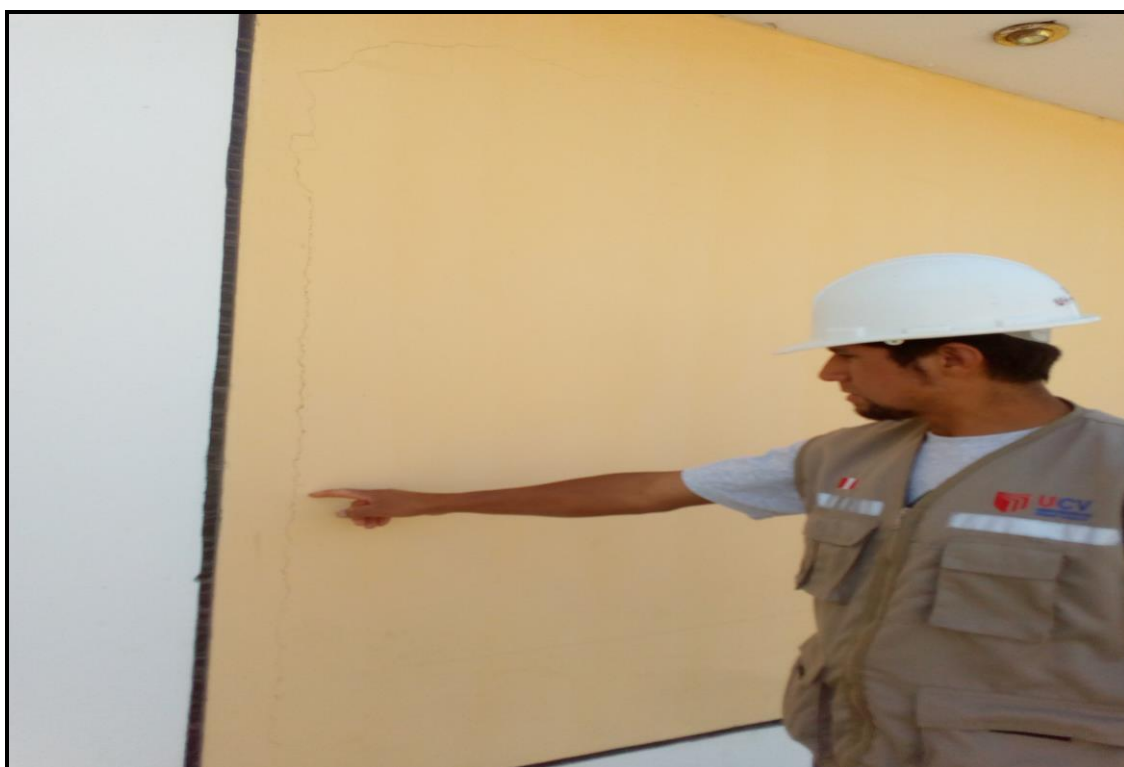
Figura N° 08: Se aprecia la fachada, afectada por fisuras en el muro.
