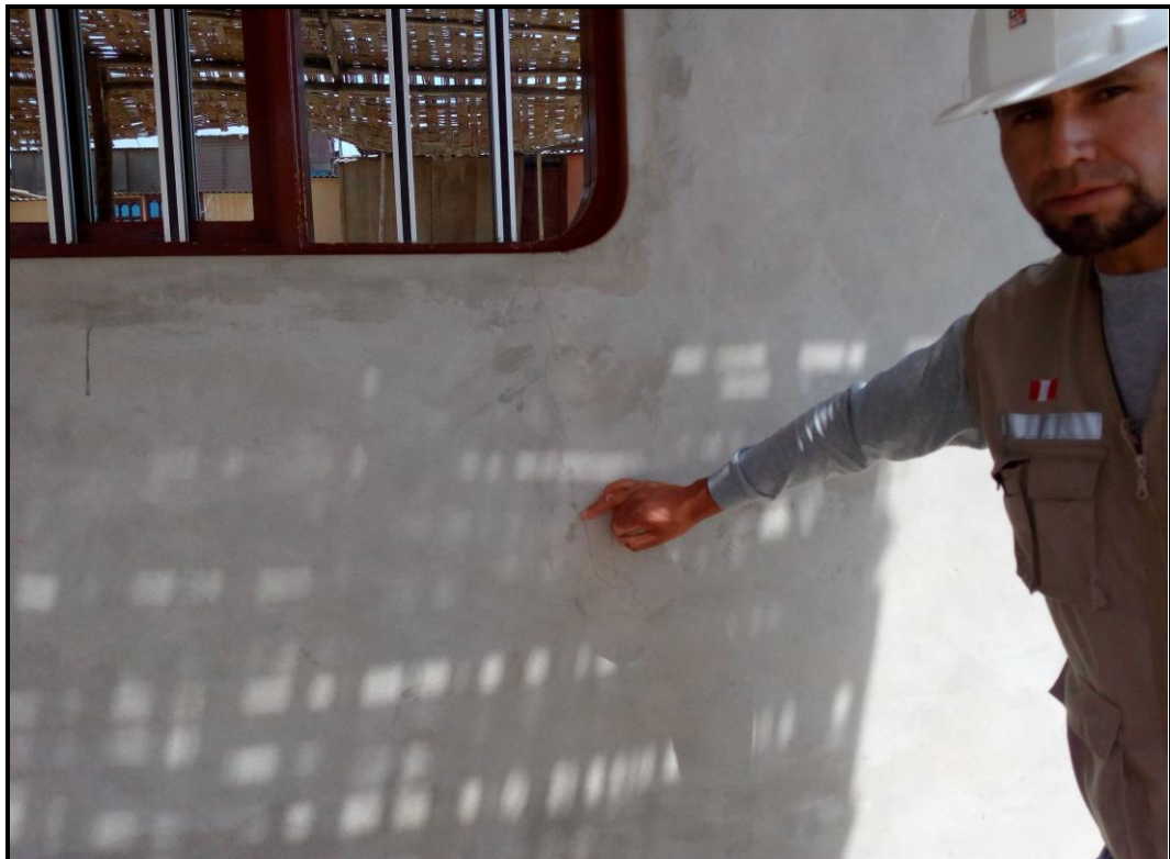
Figura N° 06: Se aprecia la fachada, afectada por fisuras en el muro.
