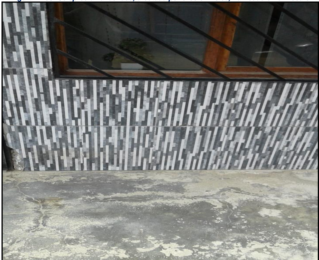
Figura N° 04: Se aprecia la fachada, afectada por humedad, fisuras y grietas en el piso
