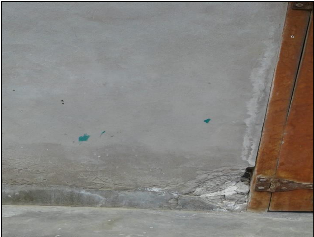
Figura N° 14: Se aprecia la fachada afectada por patologías de humedad, eflorescencia y erosión física del zócalo, columna y muro de la vivienda
