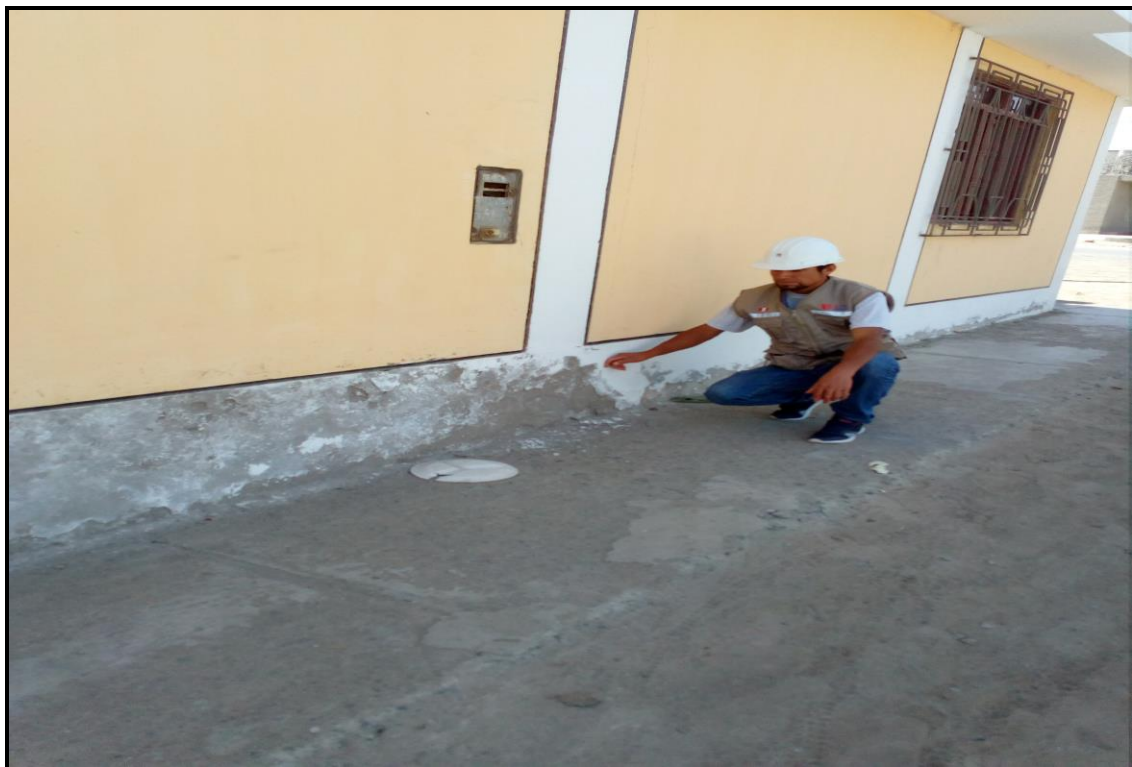
Figura N° 10: Se aprecia la fachada, afectada por erosiones en el zócalo y en el muro de la vivienda
