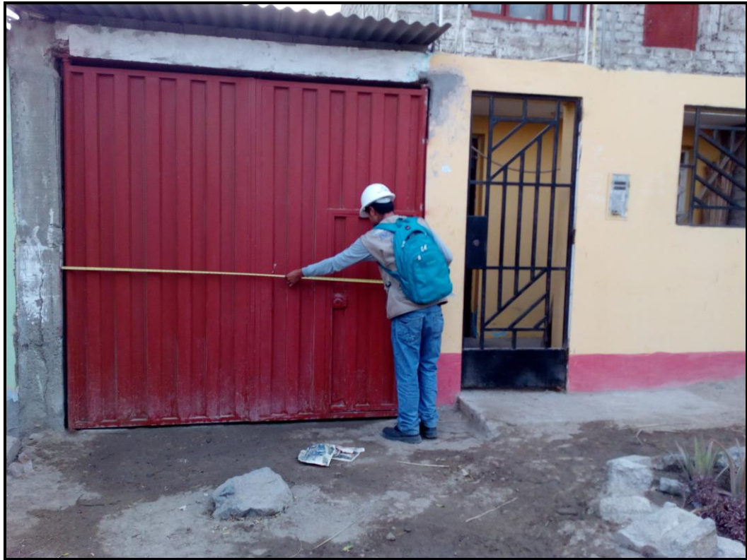
Figura N° 05: Se aprecia la fachada, afectada por fisuras y eflorescencia en la columna.
