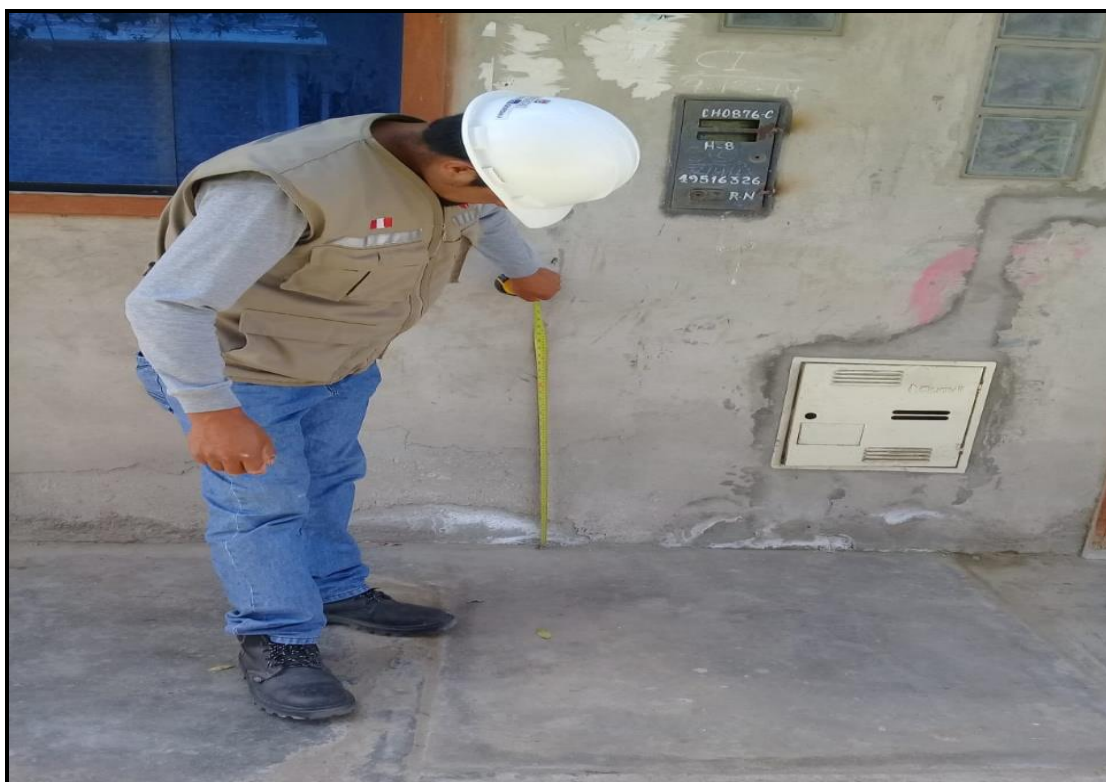
Figura N° 07: Se aprecia la medición de la fachada, para determinar el porcentaje de patología por humedad, eflorescencias afectada, en el zócalo, muro y pisos.
