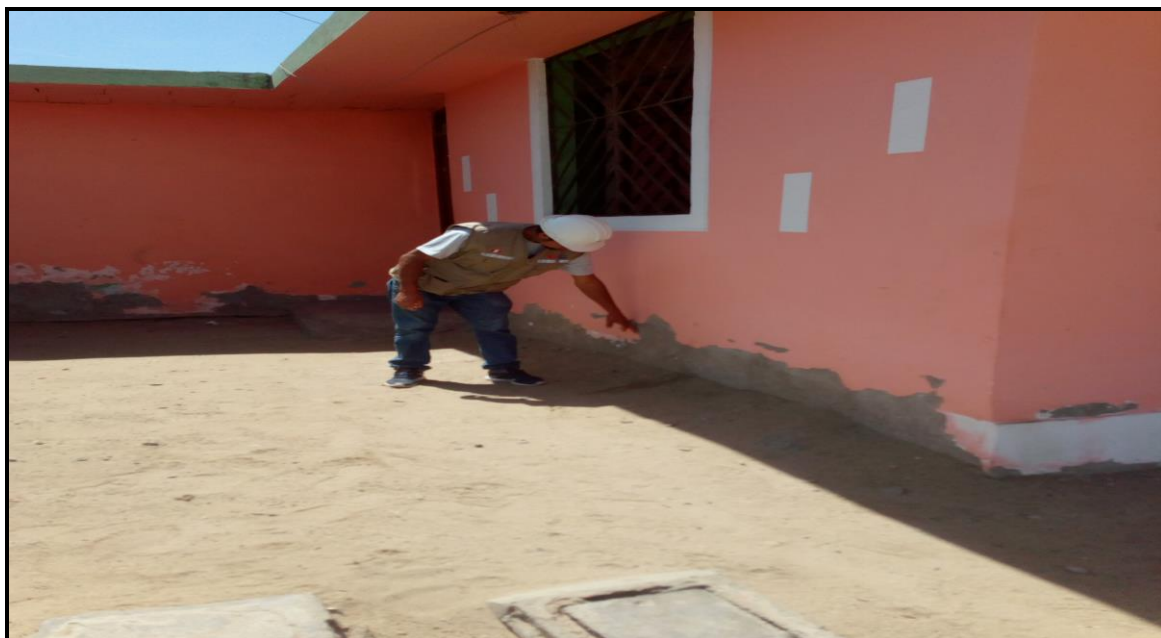
Figura N° 12: Se aprecia la fachada, afectada por patologías de humedad erosión química del zócalo y muro de la vivienda
