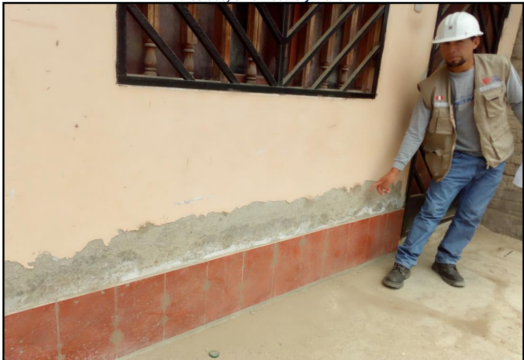
Figura N° 02: Se aprecia la fachada, afectada por erosión química, eflorescencia en el zócalo y muro.
