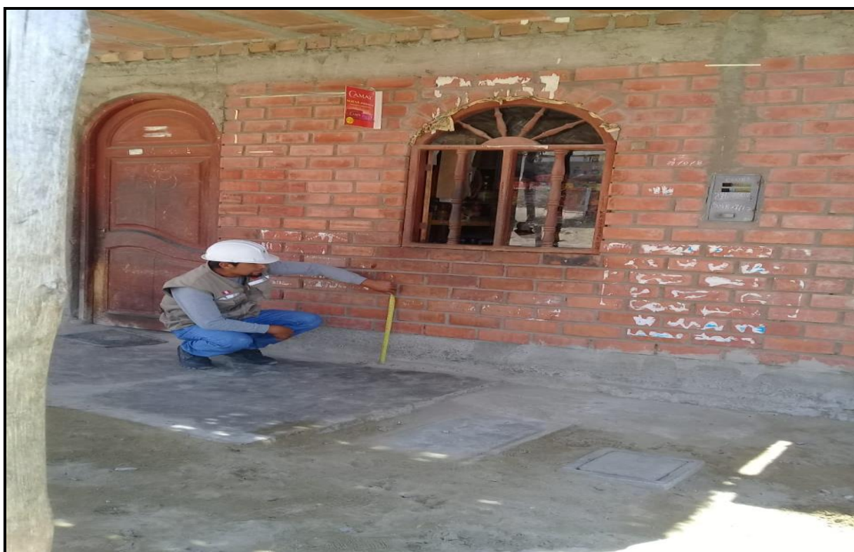
Figura N° 18: Se aprecia la medición de la fachada afectada por patologías de humedad, eflorescencia y erosión química del zócalo de la vivienda
