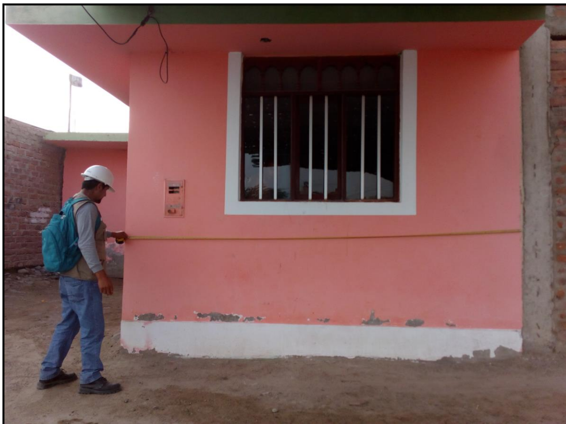
Figura N° 11: Se aprecia la medición de la fachada, para determinar el área afectada por patologías de humedad el zócalo y muro de la vivienda
