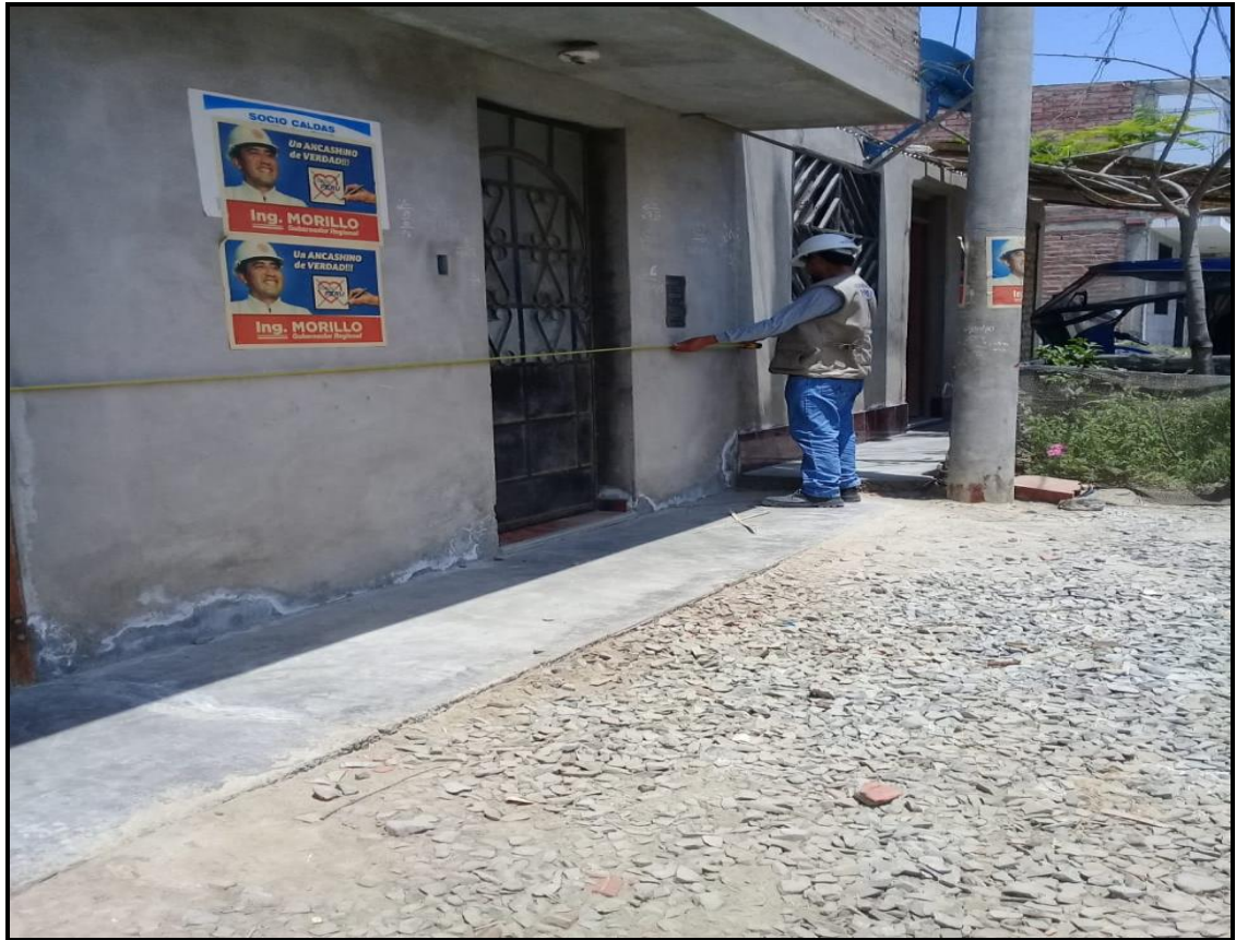
Figura N° 09: Se aprecia la medición de la fachada, para determinar el porcentaje de patología por humedad, eflorescencias, erosiones químicas que afectada, en el zócalo, muro y pisos.
