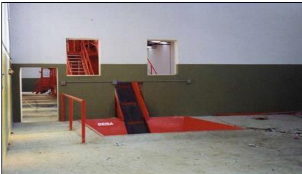
Figura 25. Tolva de Acumulación, Planta de tratamiento de “RSU” residuos sólidos urbanos con producción de energías renovables-Empresa COGERSA Fuente: http://www.cogersa.es/metaspacesportal/14498/19176 edición: propia 2017
