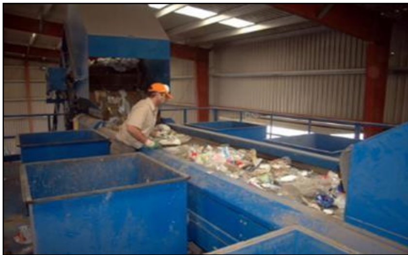
Figura 28. Cinta Transportadora de Sepacacion Manual, Planta de tratamiento de “RSU” con producción de energías renovables-Empresa COGERSA, Fuente:
