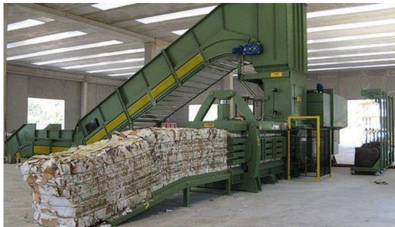
Figura 32. Compactación y apilamiento. Planta de tratamiento de “RSU” residuos sólidos urbanos con producción de energías renovables- empresa COGERSA
