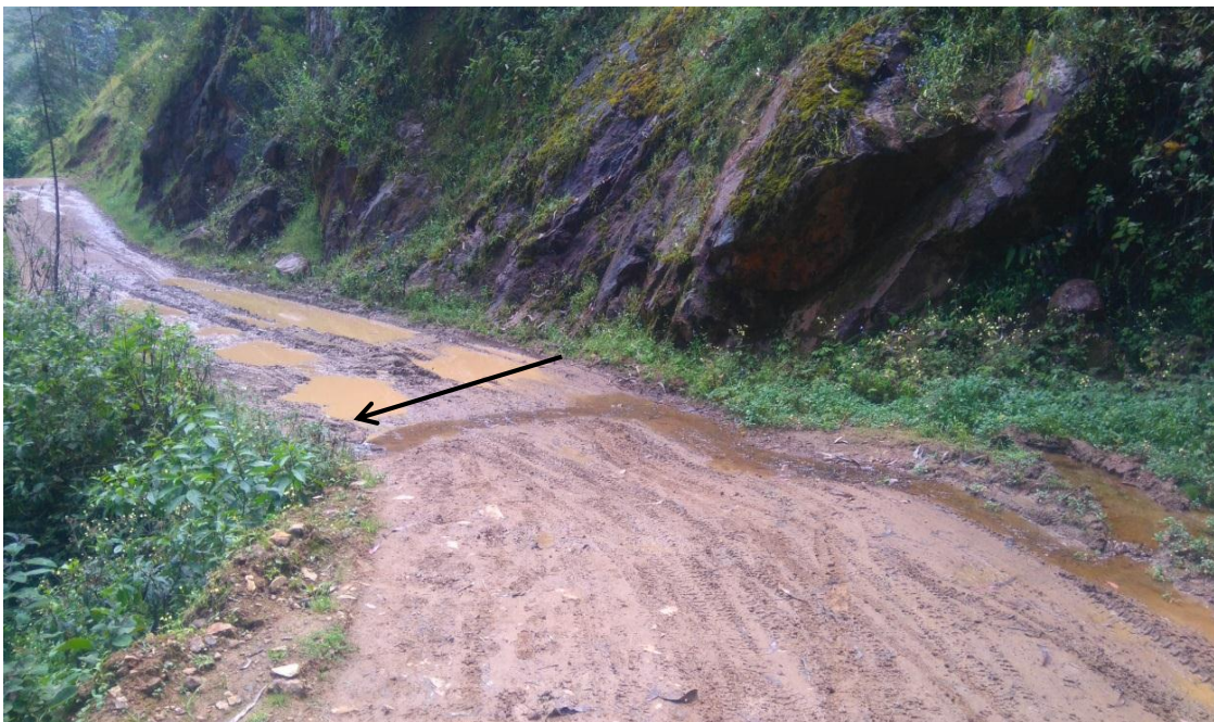
Figura 2: Se puede observar que en este punto de la vía, no existe una obra de arte para drenar las aguas superficiales.
