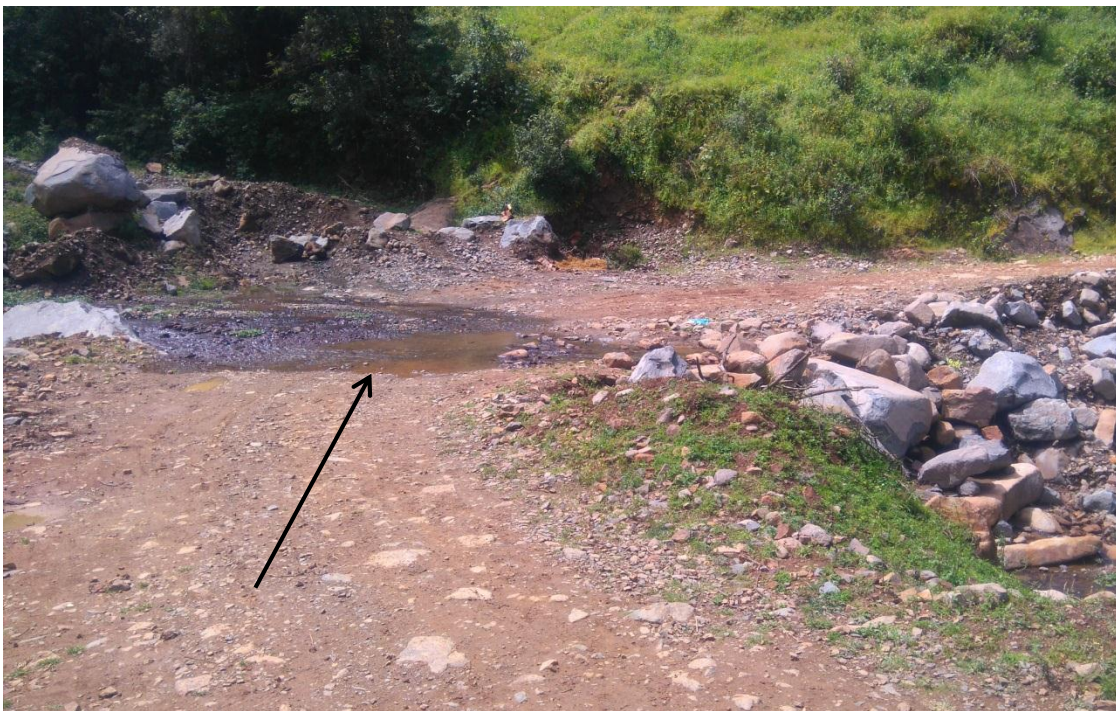
Figura 4: Se observa en la vía la falta de un badén que permita el paso de los vehículos y peatones de manera segura.
