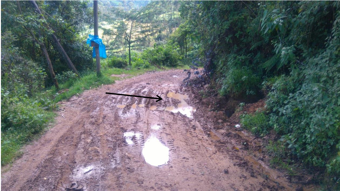
Figura 3: En la figura se observa la acumulación de las aguas superficiales en la vía, debido a la falta de alcantarillas y cunetas.
