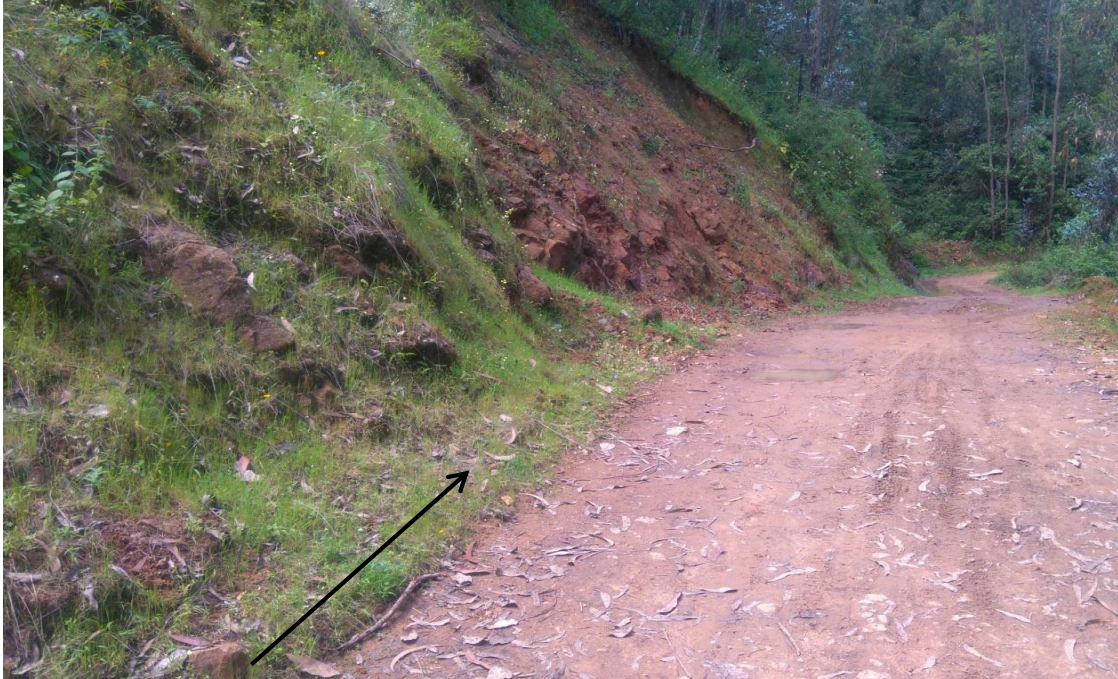
Figura 1: Se puede observar en la vía, la falta de cunetas en la parte izquierda.
