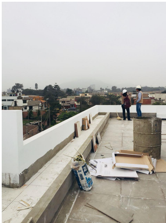
Anexo 23: Condominio Itaca, Camacho, La Molina. Proceso constructivo de jardines en la azotea. Ingeniero Civil Residente Gerardo Carmen. Fuente: Elaboración Propia. Fecha 22 de Junio de 2018.
