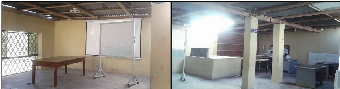
Figura 207. Ambientes del 2° piso de la Municipalidad El Trópico usado para actividades socioculturales, con deficiencias en su infraestructura. Fuente: Propia 2017
