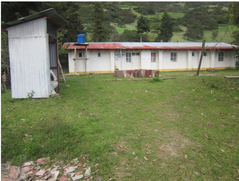
FOTO 07: SE APRECIA LA INSTALACIÓN DE LETRINA EN MAL ESTADO POSIBLE FOCO INFECCIOSO.
