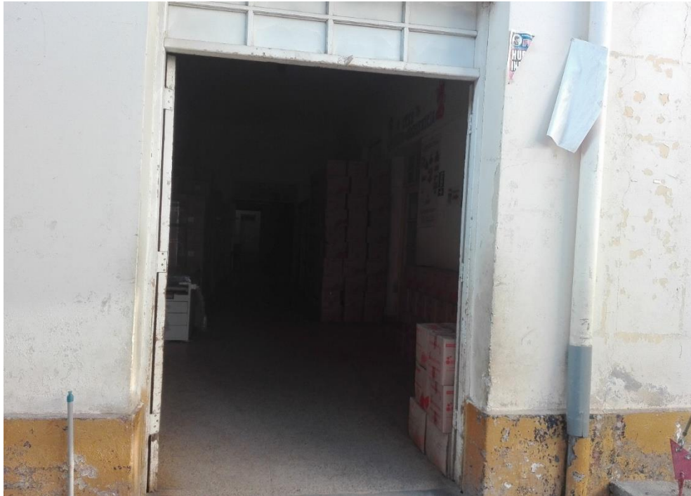
Figura 114: Deterioro de paredes al ingreso desde emergencia a consulta externa Fuente: Propia - 2016
