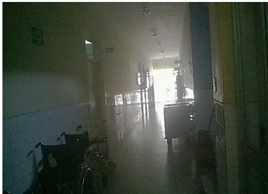
Figura 3: Pasillos de hospitalización sin iluminación. Fuente: Propia - 2016.
