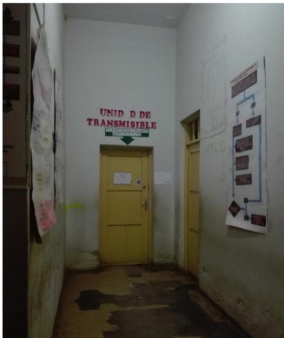
Figura 116: Deterioro de pisos en pasillo de ayuda al diagnóstico Fuente: Propia - 2016
