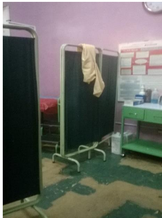
Figura 115: Deterioro de pisos en área de obstetricia Fuente: Propia - 2016
