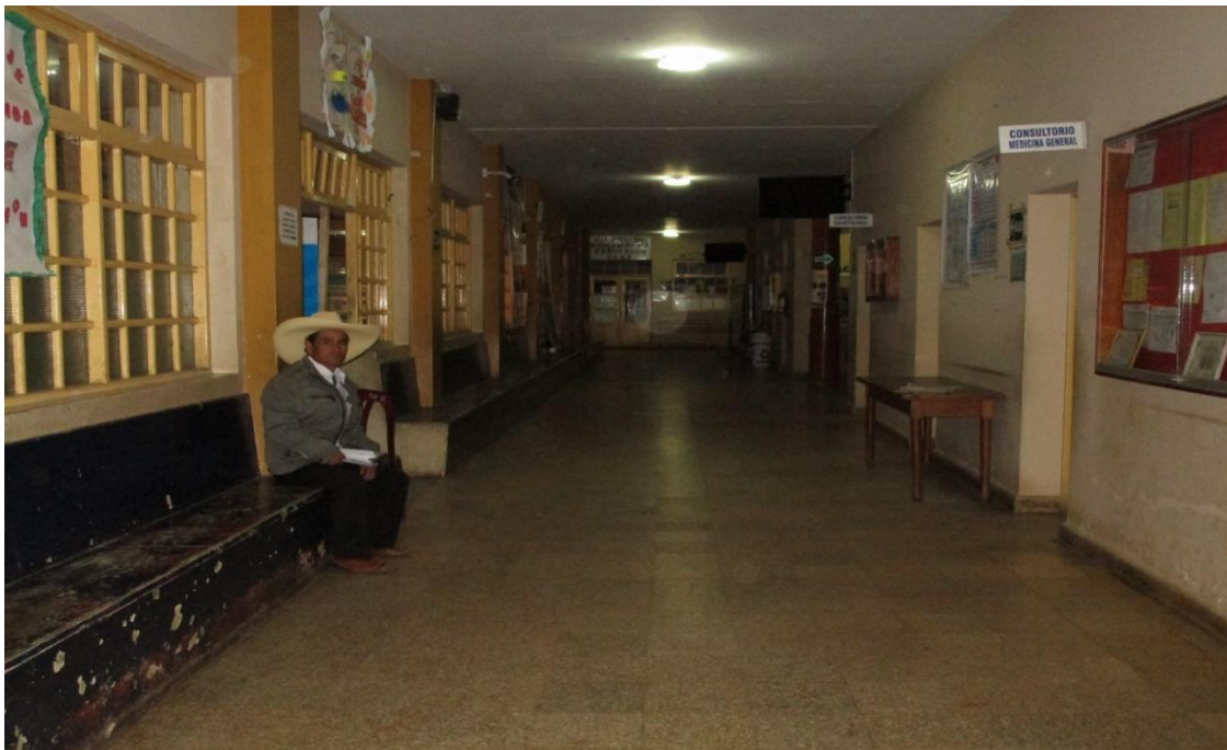
Figura 124: Pasillos de la unidad de consulta externa sin iluminación natural y con bancas de concreto en deterioro; ft. tomada a las 18.00 horas Fuente: Propia - 2016
