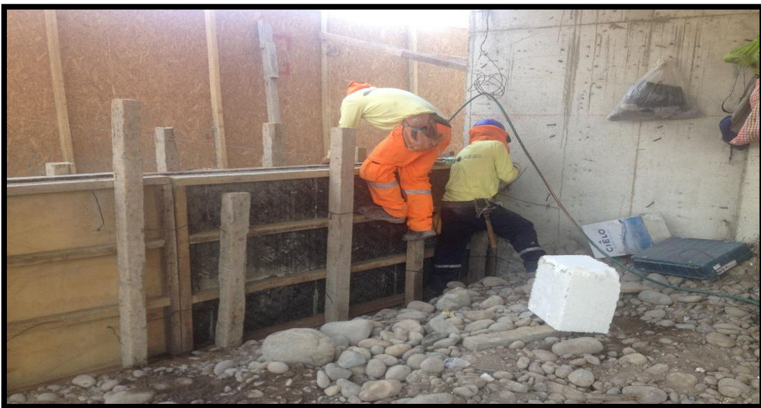
Figura 13. Sin control de calidad en encofrado y desencofrado.
