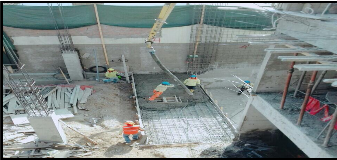
Figura 17. Sin control de calidad en el vaciado de concreto.
