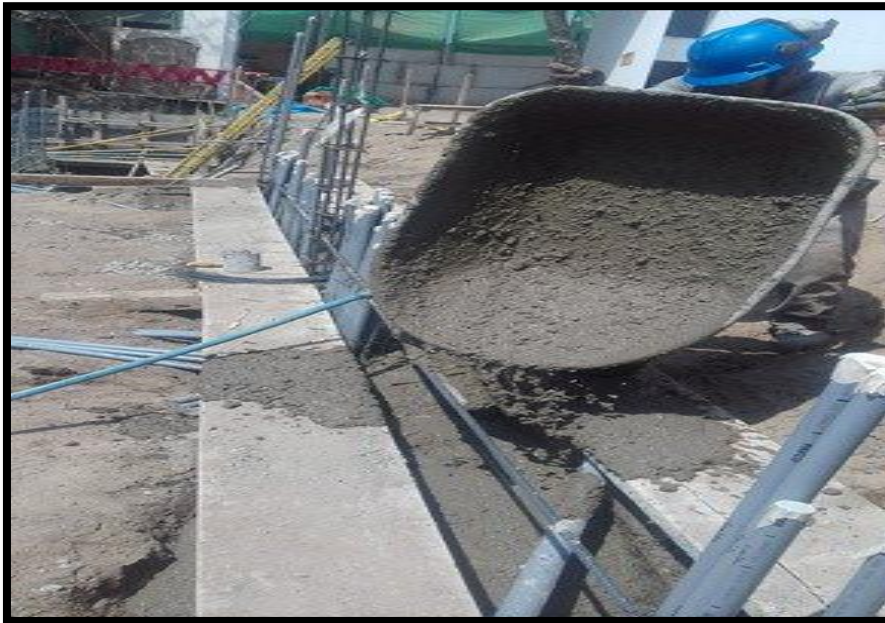
Figura 69. Pérdida de material de concreto fresco.
