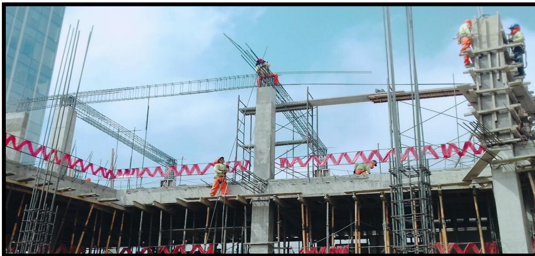
Figura 9. Sin control de calidad en armado de acero.
