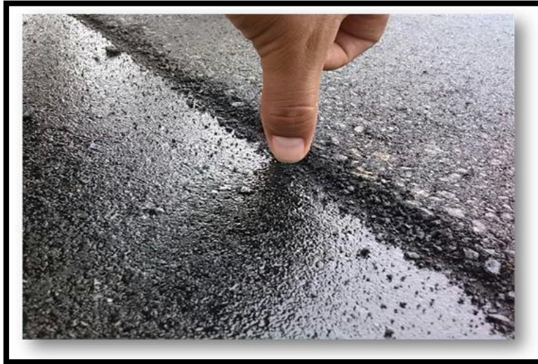
Figura N° 1 Pavimento dañado Fuente: Elaboración Propia
