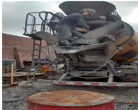
Figura N° 02: Rotura de concreto en el chute del Mixer.
