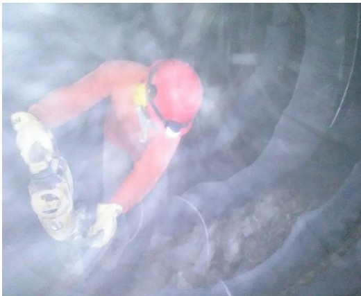
Figura N° 01: Rotura de concreto en el interior del tambor giratorio del Mixer.
