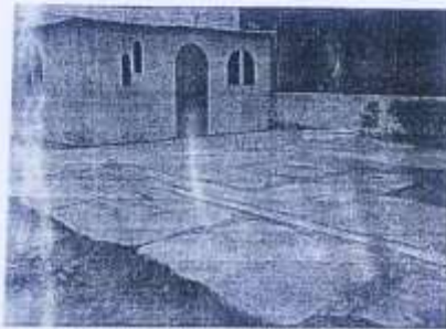
En la vista se observa el patio central en mal estado.
