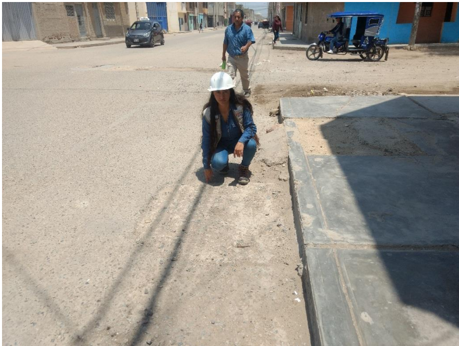
Figura 19 : Tipo de falla (grieta por fatiga).
