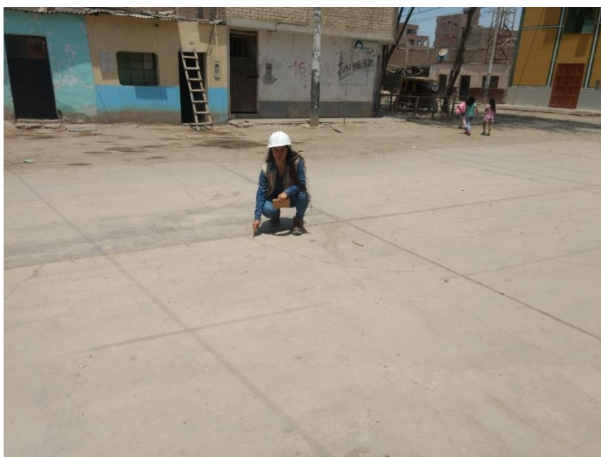
Figura 24: Tipo de Falla (grietas de esquina)
