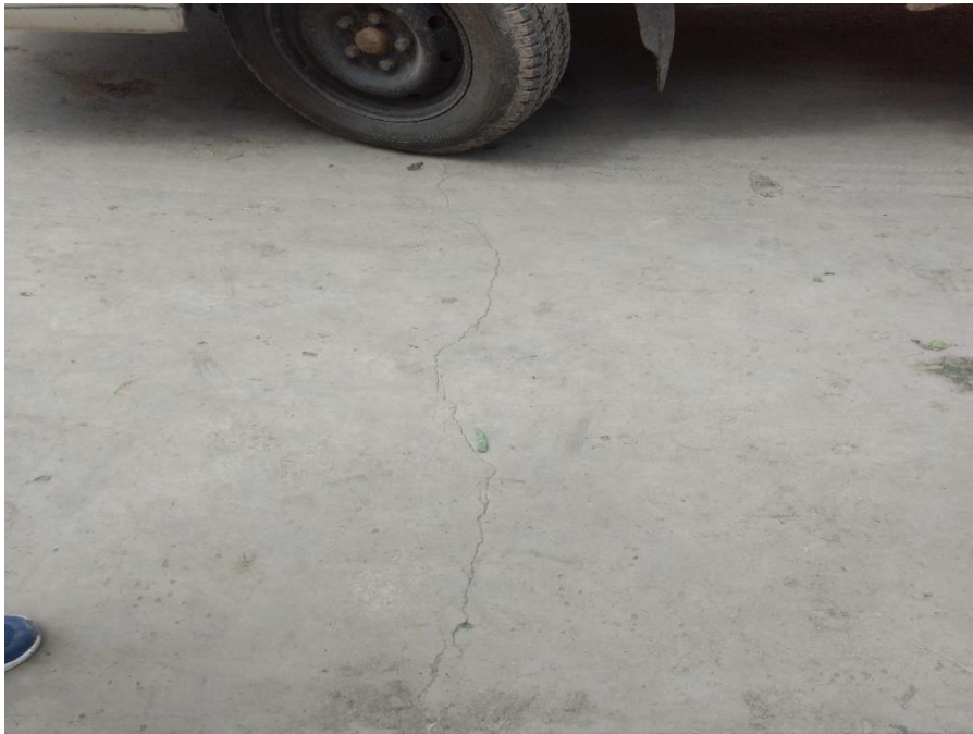
Figura 26: Tipo de Falla (grietas longitudinales)
