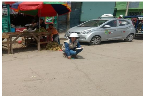
Figura 8: Fallas en pavimento rígido (cuadra 23 Av. Venezuela).
