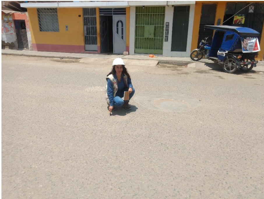
Figura 20 : Tipo de falla (Ahuellamiento)
