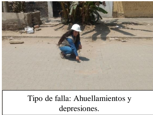
Figura 9: Fallas en pavimento articulado (cuadra 12 prolg. Venezuela).
