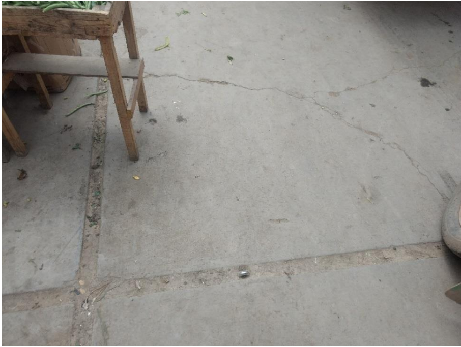
Figura 25: Tipo de Falla (grietas de esquina)
