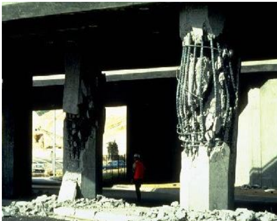
Figura 13. Terremoto de 1971 en San Fernando, California. Estas columnas soportaban un puente, el daño que se presentó se debió a torsión.
