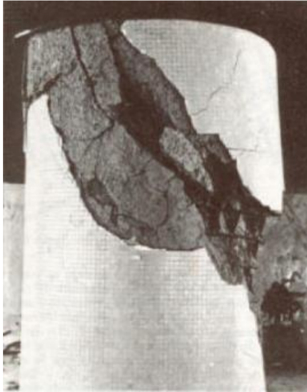
Figura 14. Falla de cortante por tensión diagonal. Fuente: Fernando San Martín Suárez.
