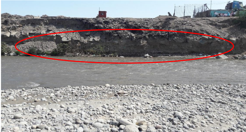
Figura 17. Deslizamiento del terreno. (Fuente: Imagen propia, 2019)
