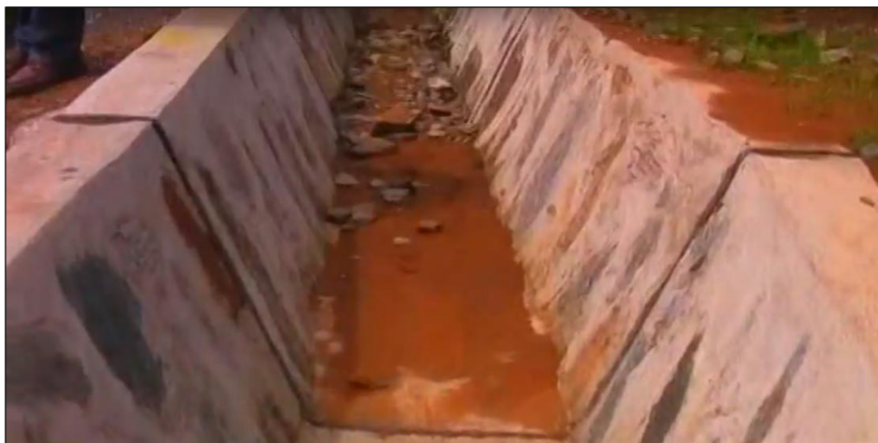
Figura 17. Canal de coronación con residuos. Fuente. Elaboración propia
