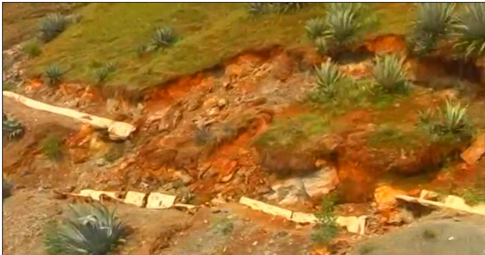
Figura 16: Canal de coronación colapsado. Fuente. Elaboración propia
