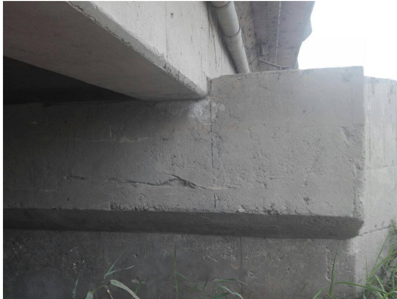
Vista de los pilares del Puente Chancay en sentido de la via Sur a Norte
