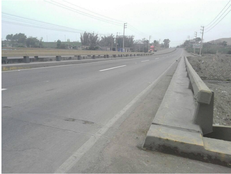
Vista de la carpeta asfáltica del Puente Chancay en sentido Sur a Norte, presenta grietas de 2 cm y exudación, en la cual en esta parte la carpeta asfáltica tiene una forma de ondas
