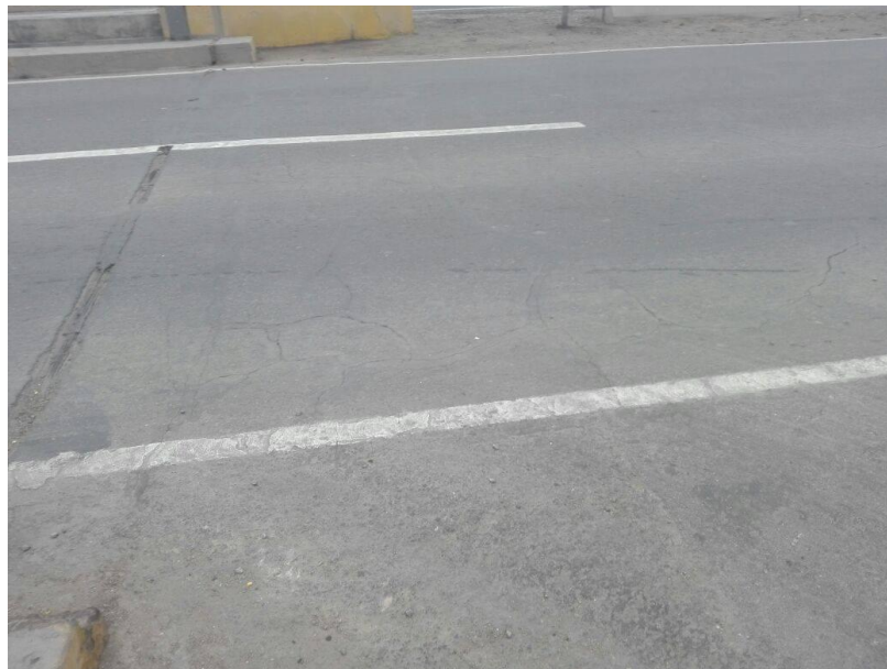
Vista de la carpeta asfáltica del Puente Chancay en sentido Sur a Norte, presenta fallas por degradación y piel de cocodrilo
