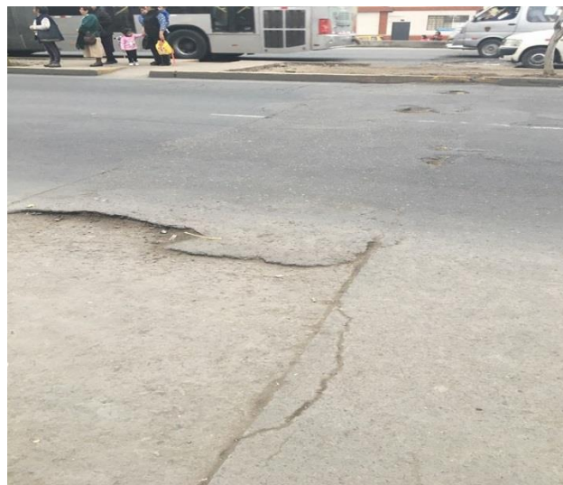
Figura 2 Av. Tupac Amaru km 11 Comas – Falla en el pavimento (Desnivel de carril/berma)
