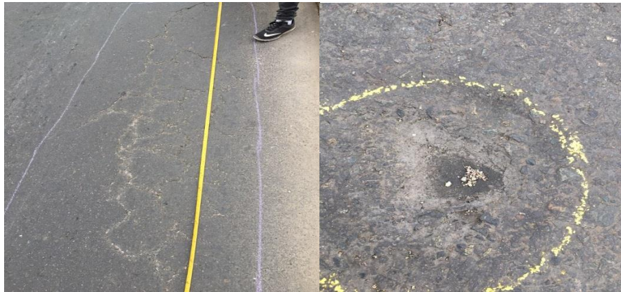
Figura 11. Mediciones de fallas en la Av. Tupac Amaru intersección Av. Puno Fuente: Propia
