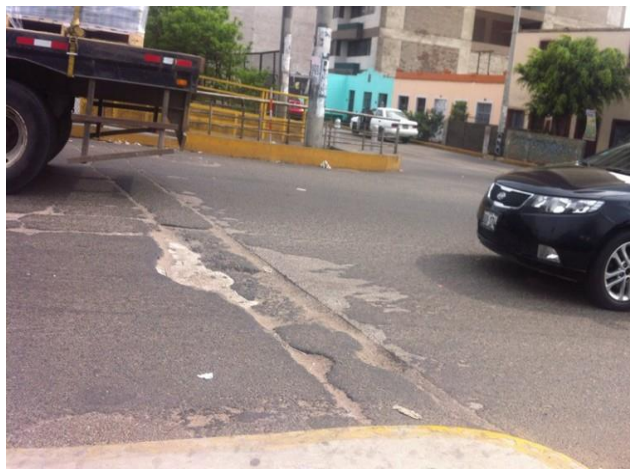
Figura 1 Av. Tupac Amaru km 11 Comas – Falla en el pavimento (Huecos)
