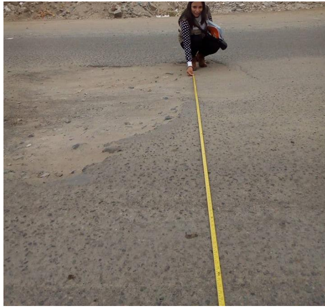
Foto N° 05: La carpeta asfáltica no es óptima para el tránsito vehicular
