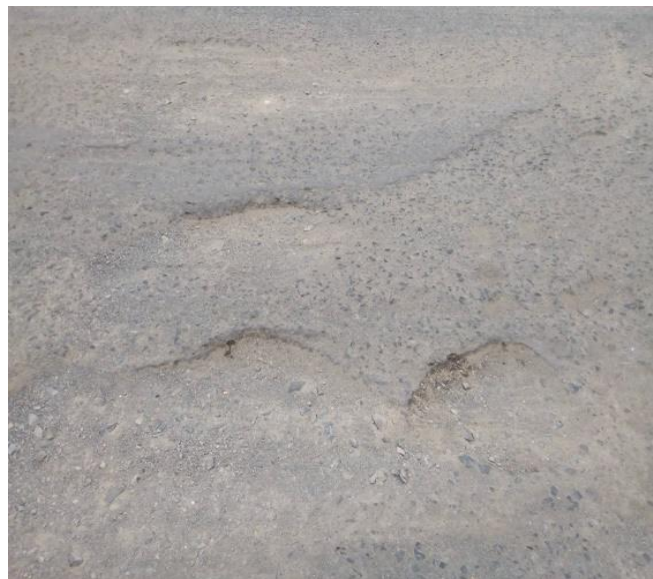
Foto N° 04: Encontramos huecos, son depresiones en la superficie del pavimento
