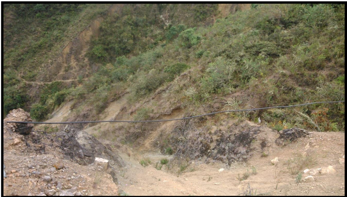
IMAGEN 6: CONDUCCION ACTUAL DE AGUA
