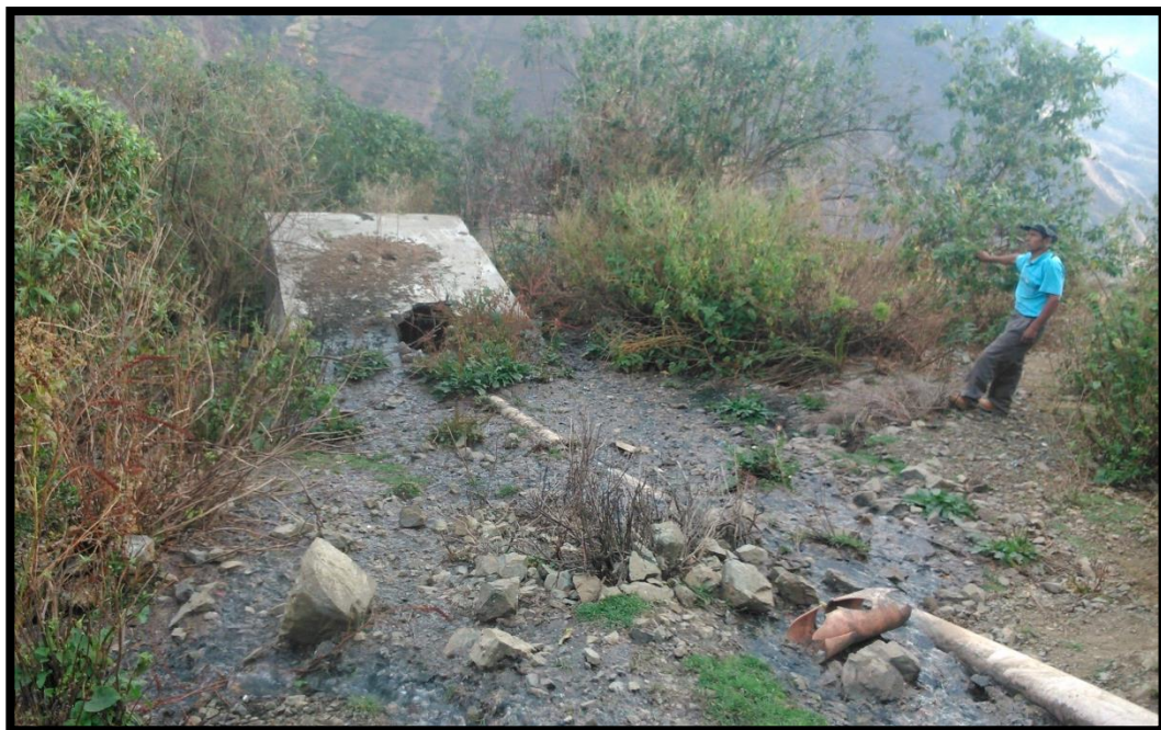
IMAGEN 12: CONEXIONES Y ESTRUCTURAS EXISTENTES
