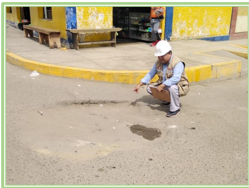
Deterioro del pavimento (Hueco) en la Zona Centro – Calle Principal
