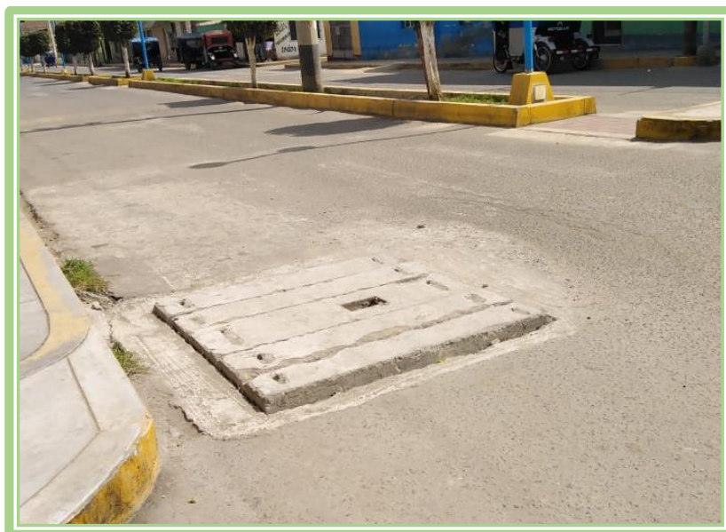
Deterioro del pavimento (Parches) en la Zona Centro – Calle Principal
