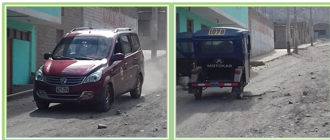
Deterioro del pavimento (Desprendimiento de Carpeta) en la Zona Alta
