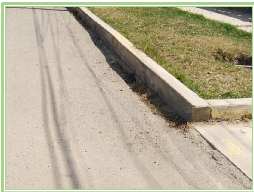
Deterioro del pavimento (Hundimiento) en la Zona Alta – Calle Principal del Colegio
