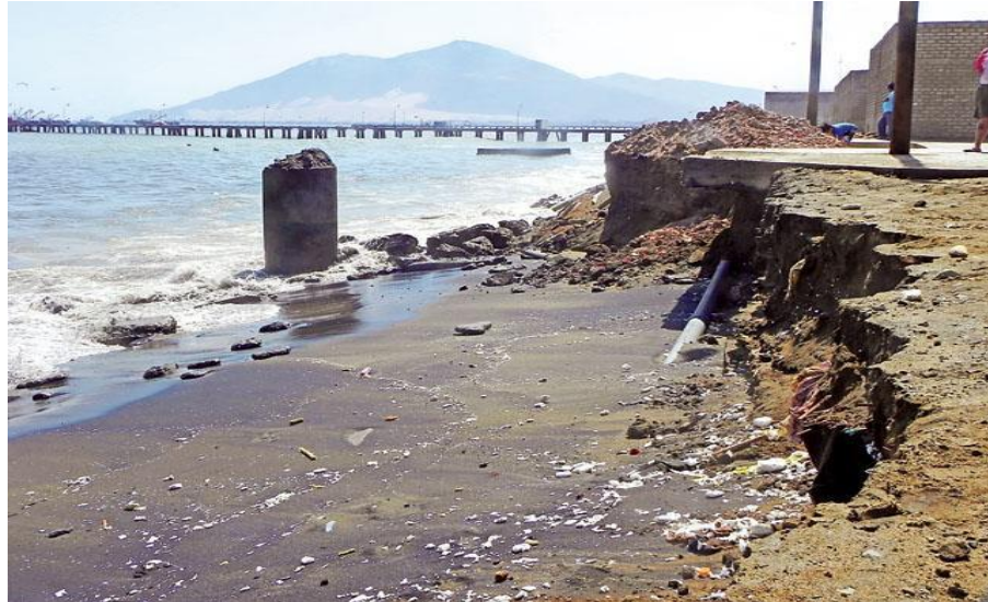
FIGURA 17: erosión ocasionado por la bahía Fuente: (proactivo.com,2015)
