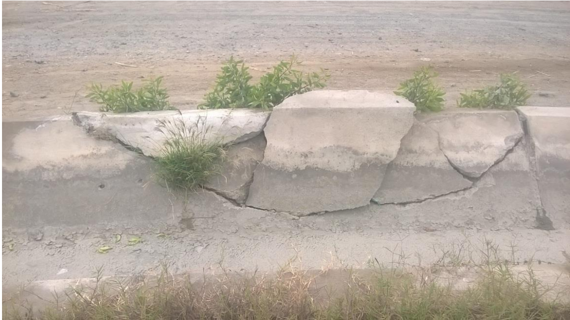
Fotografía N° 5. Identificación de la patología desprendimiento en el margen derecho del canal integrador N° 9.
