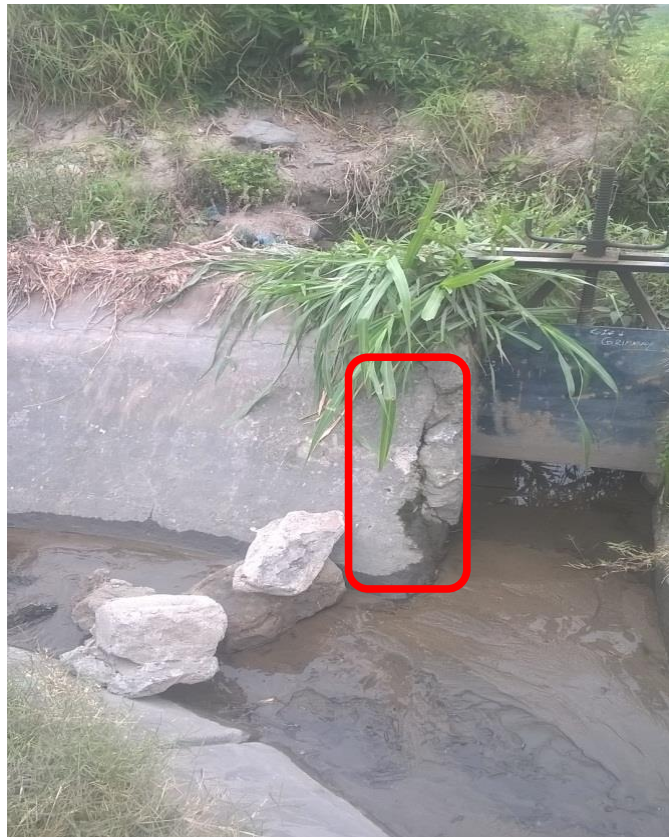
Fotografía N° 2. Identificación de la patología desprendimiento.
