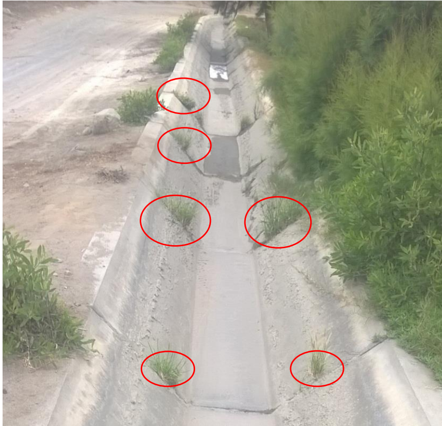
Fotografía N° 3. Identificación de la patología vegetación en las juntas del canal.
