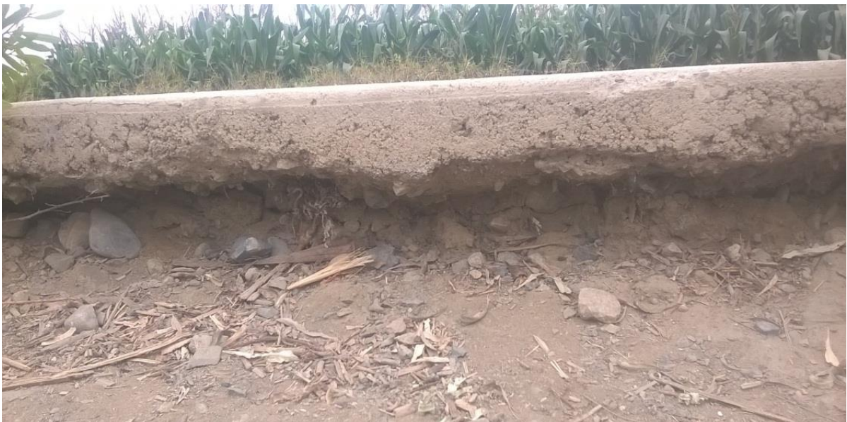
Fotografía N° 4. Identificación de la patología socavación en canal integrador N° 9.
