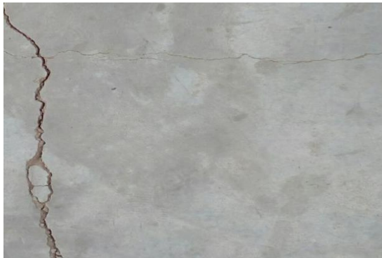
Figura 1. Propagación de rajadura en la superficie en la estructura Fuente: Propia.
