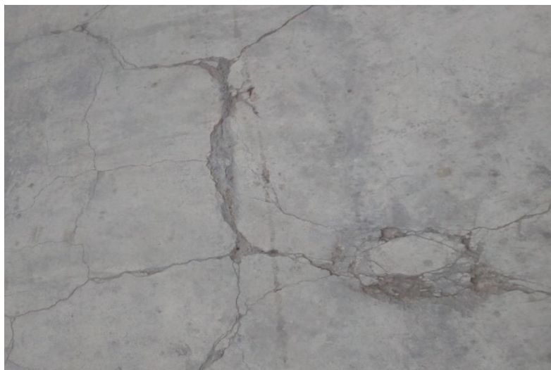
Figura 2. Rajadura, desgaste y degradación de la estructura. Fuente: Propia.
