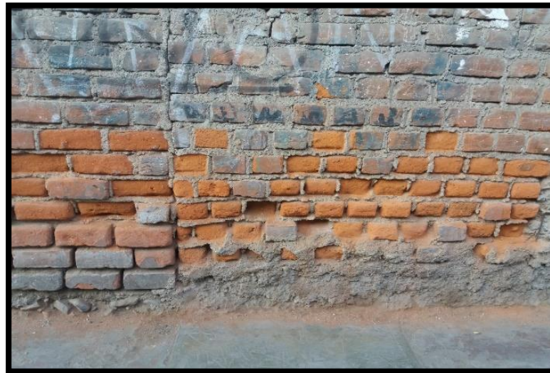
Figura 2: Muro confinado afectado por criptoflorescencia
