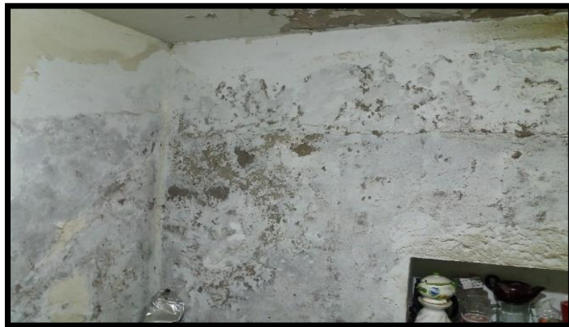
Figura 1: Muro confinado afectado por eflorescencia
