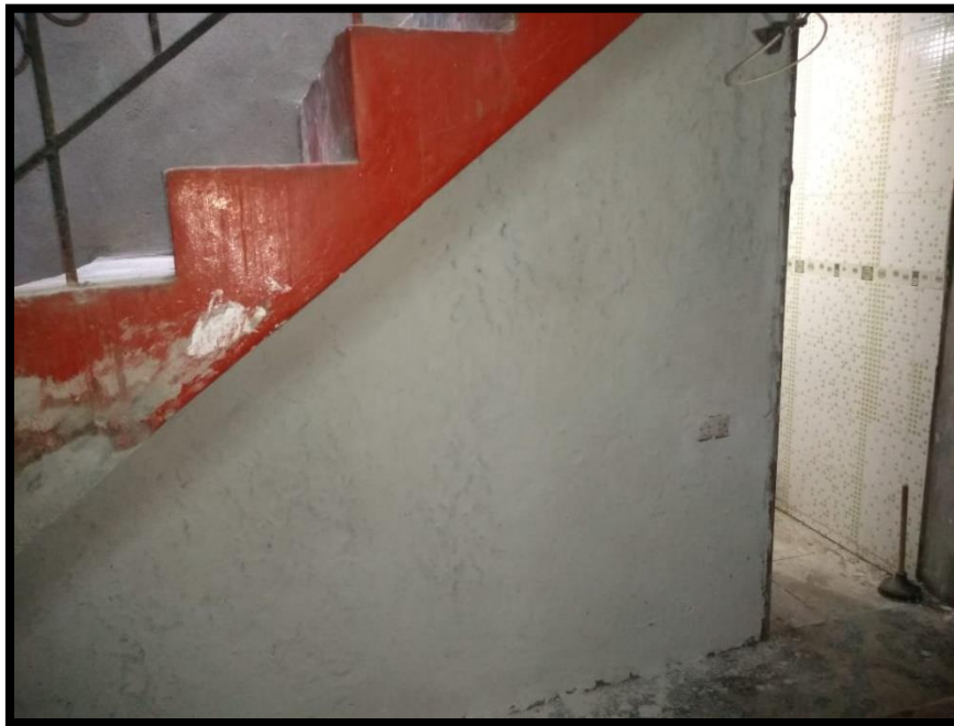
Figura 14: Evidencia 11 (Muro reforzado contra la eflorescencia)
