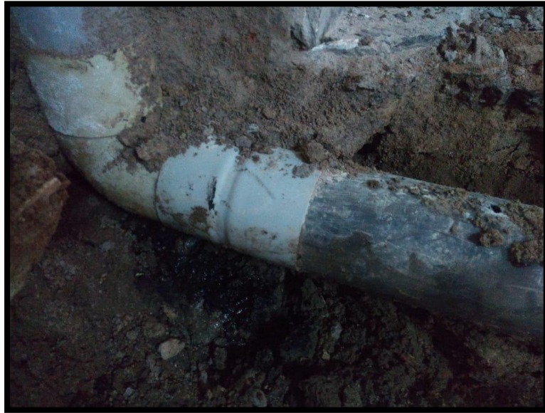
Figura 4: Evidencia 1 (Codo de PVC de 4" dañado)
