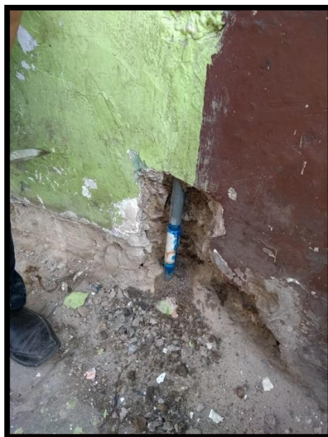
Figura 15: Evidencia 12 (Tubería de agua de 1" con fisura)
