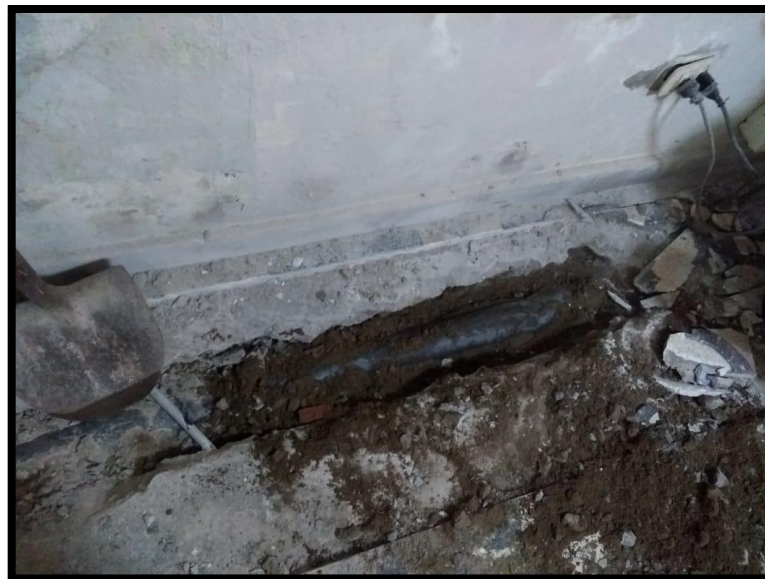
Figura 5: Evidencia 2 (Tubería de 4" dañada y enterrada en el piso)
