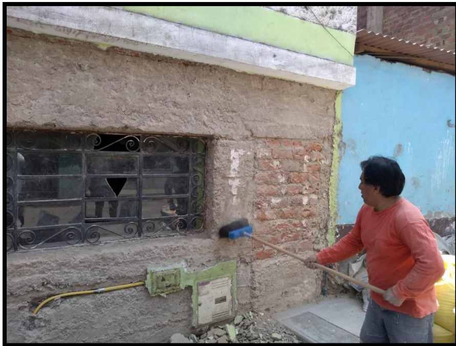
Figura 17: Evidencia 14 (Limpieza de sales)
