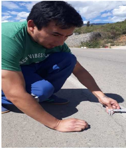
FOTO N° 21: Falla "Fisuras de Borde"; UM 110; PROG 03+815; SEVERIDAD BAJO
