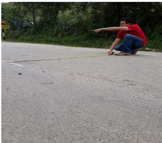
FOTO N° 05: Falla "Ahuellamiento" UM 37; PROG 01+260; SEVERIDAD BAJO
