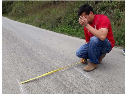
FOTO N° 15: Falla "Peladura por Intemperismo y Desprendimiento de Agregados" UM 91; PROG 03+150; SEVERIDAD BAJO
