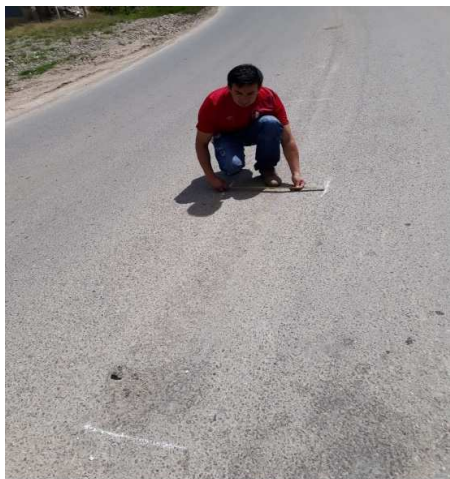
FOTO N° 30: Falla "Peladura por Intemperismo y Desprendimiento de Agregados" UM 146; PROG 05+075; SEVERIDAD BAJO
