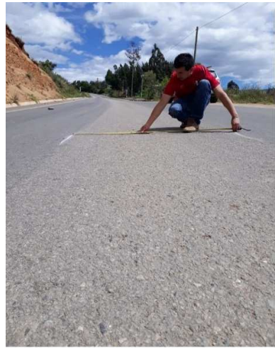
FOTO N° 17: Falla "Agregado Pulido" UM 92; PROG 03+185
