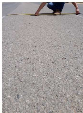
FOTO N° 13: Falla "Peladura por Intemperismo y Desprendimiento de Agregados" UM 80; PROG 02+765; SEVERIDAD BAJO
