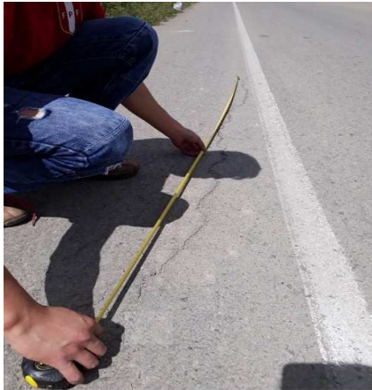
FOTO N° 25: Falla "Fisuras de Borde" UM 134; PROG 04+655; SEVERIDAD BAJO
