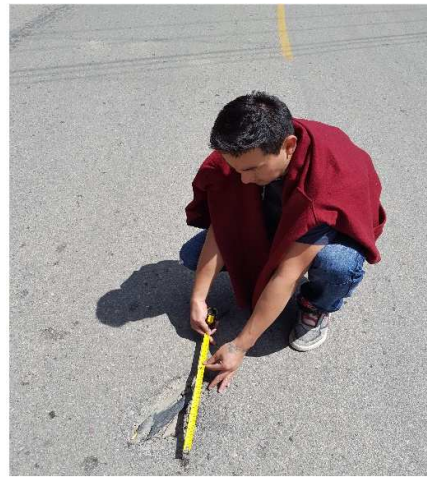
FOTO N° 24: Falla "Baches" UM 133; PROG 04+620 SEVERIDAD BAJA
