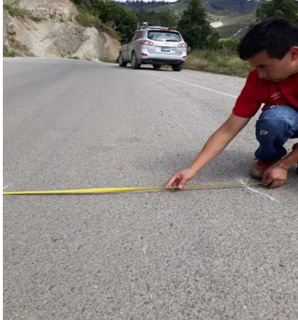
FOTO N° 10: Falla "Ahuellamiento" UM 68; PROG 02+345; SEVERIDAD BAJO
