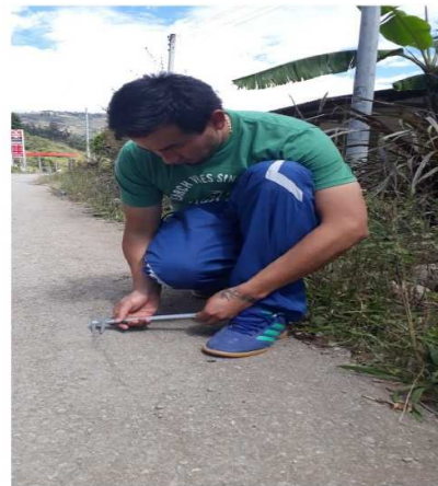
FOTO N° 20: Falla "Fisura de Borde"; UM 109; PROG 03+780; SEVERIDAD BAJO
