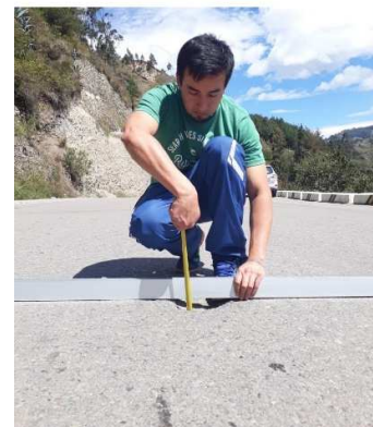
FOTO N° 14: Falla "Baches"; UM 80; PROG 02+765; SEVERIDAD BAJO
