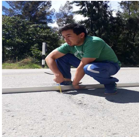
FOTO N° 32: Falla "Bache"; UM 169 ; PROG 05+880; SEVERIDAD BAJO
