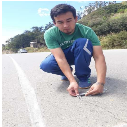
FOTO N° 26: Falla "Fisuras Longitudinales y transversales"; UM 134; PROG 04+655
