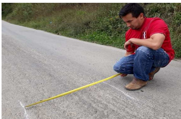
FOTO N° 04: Falla "Ahuellamiento" UM 20; PROG 00+665; SEVERIDAD BAJA
