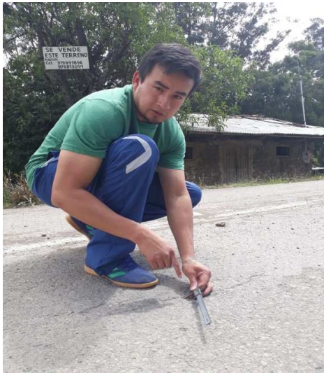
FOTO 01: Falla "Fisuras Longitudinales y Transversales"; UM 07; PROG 00+210; SEVERIDAD BAJO
