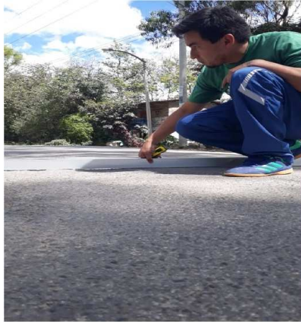
FOTO N° 31: Falla "Ahuellamiento"; UM 158; PROG 05+495; SEVERIDAD BAJO
