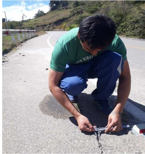
FOTO N° 29: Falla "Fisuras de Borde"; UM 145 PROG 05+040; SEVERIDAD MEDIA
