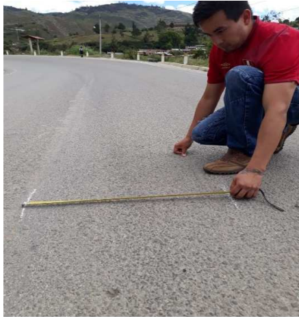
FOTO N° 23: Falla "Agregado Pulido" UM 133; PROG 04+620
