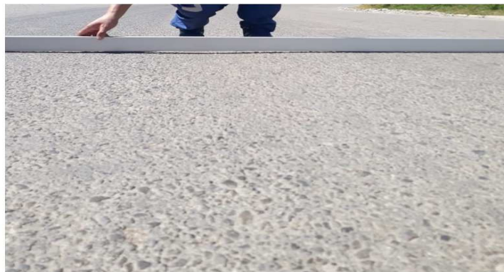
fOTO N° 03: Falla "Ahuellamiento"; UM 19; PROG 00+630; SEVERIDAD BAJO
