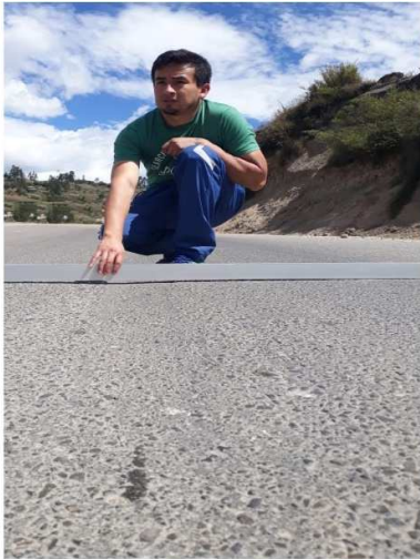
FOTO N° 16: Falla "Ahuellamiento"; UM 92; PROG 03+185; SEVERIDAD BAJO
