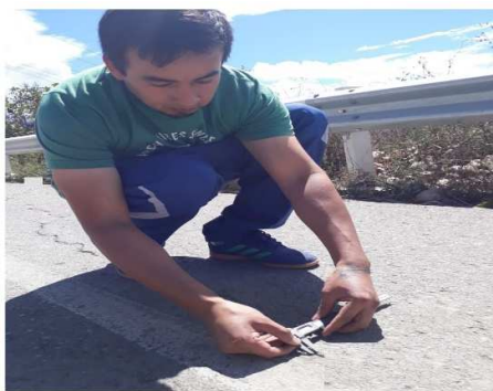
FOTO N° 08: Falla "Fisuras de Borde" UM 56; PROG 01+925; SEVERIDAD BAJO
