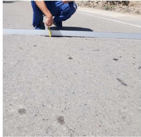
FOTO N° 22: Falla "Ahuellamiento"; UM 110; PROG 03+815; SEVERIDAD BAJO
