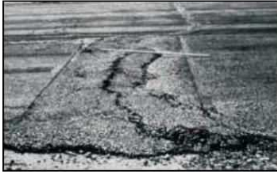
Figura 2.20 Hinchamiento de alta severidad. (Fuente: Rodríguez, 2009)
