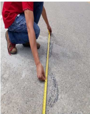
FOTO N° 12: "Fisuras Longitudinales y Transversales" UM 80; PROG 02+765; SEVERIDAD BAJO
