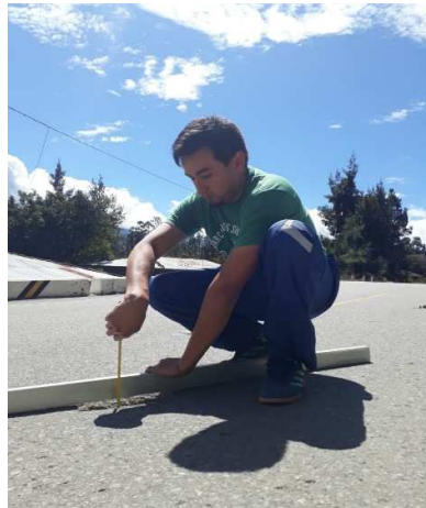
FOTO N° 27: Falla "Baches"; UM 139; PROG 04+830; SEVERIDAD BAJO
