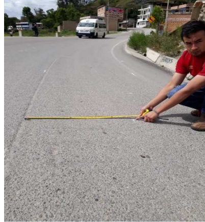
FOTO N° 11: Falla "Peladura por Intemperismo y Desprendimiento de Agregados" UM 68; PROG 02+345; SEVERIDAD BAJO
