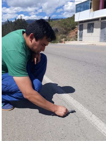
FOTO N° 07: Falla "Fisuras de Borde"; UM 49 PROG 01+680; SEVERIDAD BAJO
