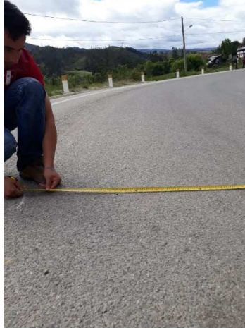
FOTO N° 18: Falla "Peladura por Intemperismo y Desprendimiento de Agregados" UM 104; PROG 03+605; SEVERIDAD BAJO
