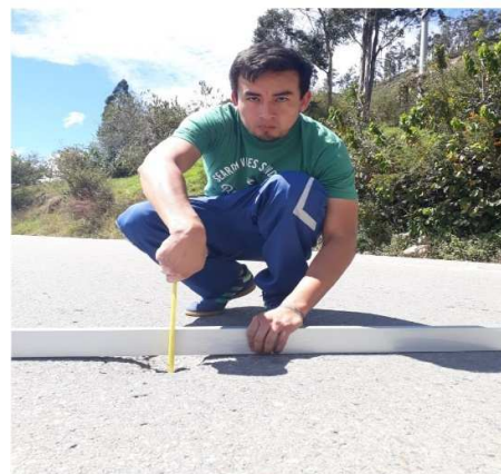
FOTO N° 06: Falla "Baches"; UM 37 ; PROG 01+260; SEVERIDAD BAJO
