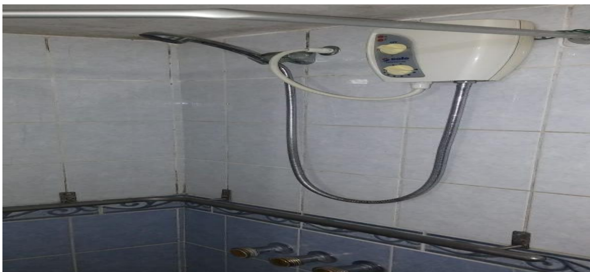
Figura 8. Ducha eléctrica con fuga de agua
