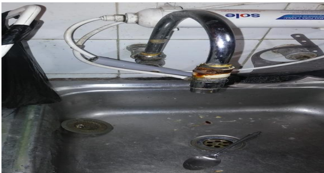
Figura 5. Grifería en mal estado
