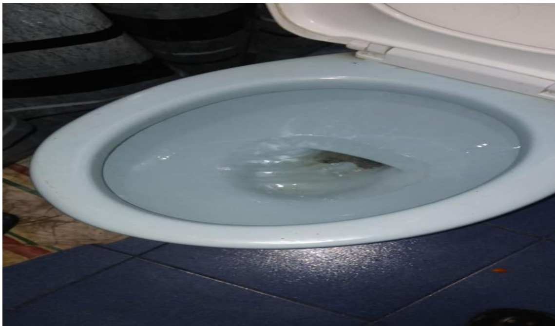
Figura 7. Inodoro con fuga de agua
