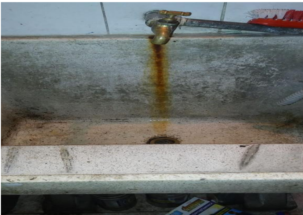
Figura 4. Cañería obsoleta en vivienda de la Urbanización Santa Felicia
