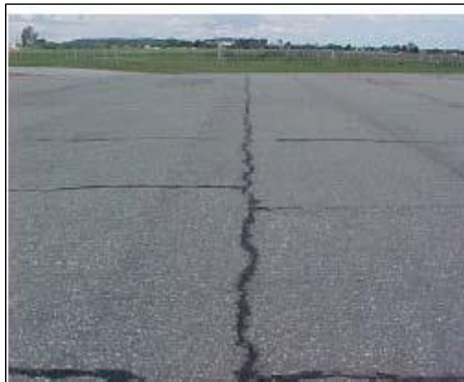
Figura 20. Reflexión de juntas de severidad media
