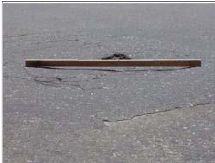
Figura 16. Depresión de severidad media.
