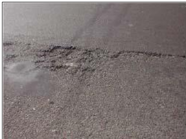
Figura 30. Peladura de severidad alta.
