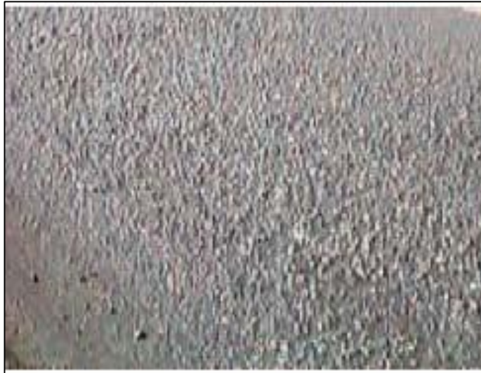
Figura 29. Peladura de severidad media.
