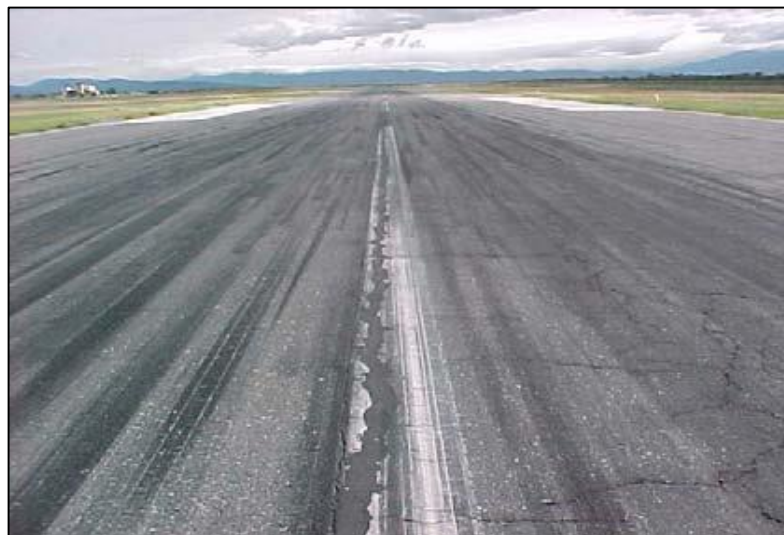
Figura 9. Fisura de bloque severidad baja.
