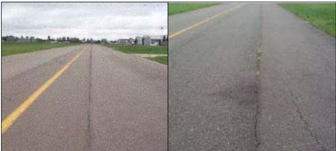
Figura 2242. Fisuras longitudinales y transversales de severidad baja y media.
