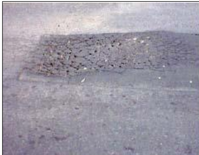
Figura 26. Bacheo de severidad alta.
