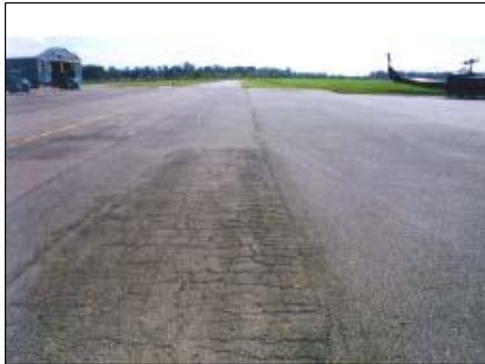
Figura 4. Piel de cocodrilo de severidad media.
