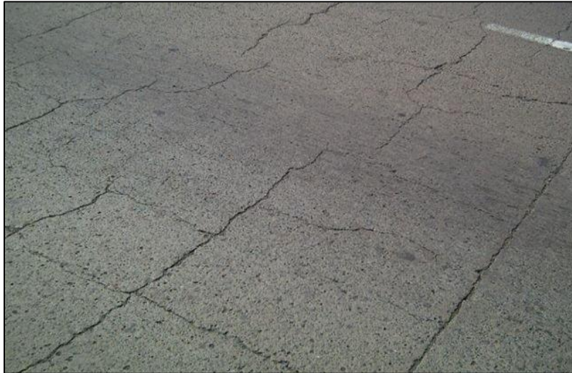
Figura 10. Fisura de bloque de severidad media.
