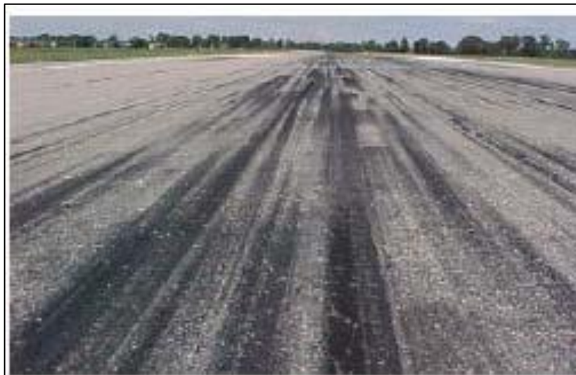
Figura 18. Erosión chorro de turbina no hay niveles de severidad definido.
