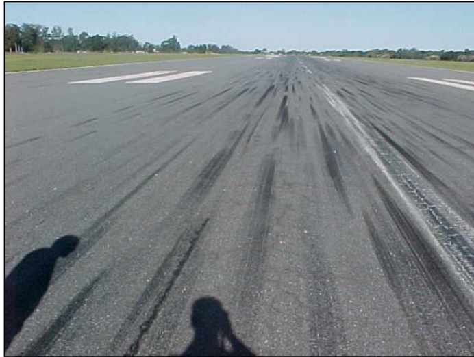
Figura 3. Piel de cocodrilo de severidad baja.
