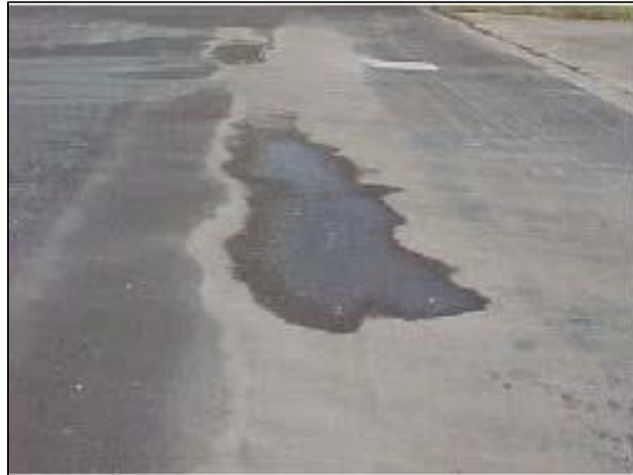
Figura 17. Depresión de severidad alta.
