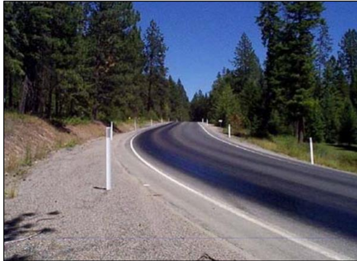
Figura 8. Exudación de severidad alta.
