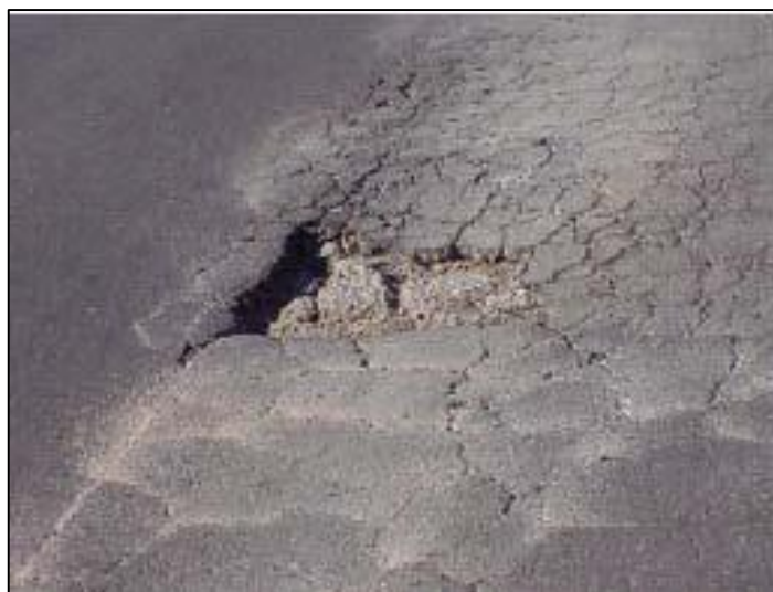
Figura 5. Piel de cocodrilo de severidad alta
