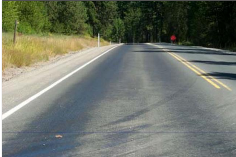
Figura 6. Exudación de severidad baja.
