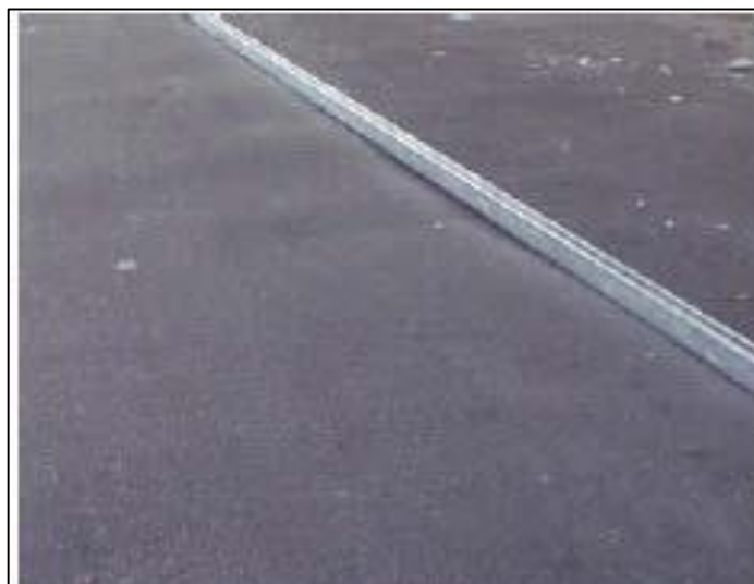
Figura 1441. Ondulación de severidad baja.
