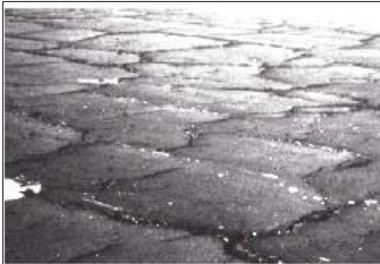
Figura 1140. Fisura de bloque de severidad alta.
