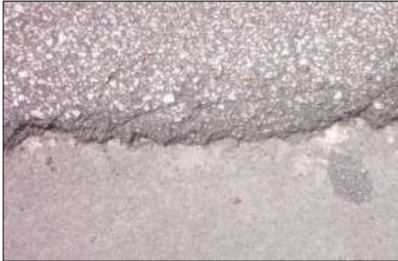
Figura 33. Ahuellamiento de severidad media.
