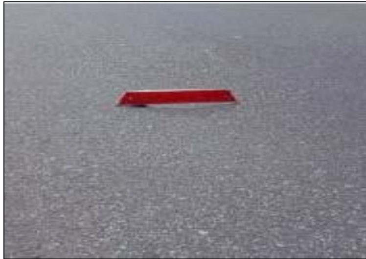
Figura 15. Depresión de severidad baja.
