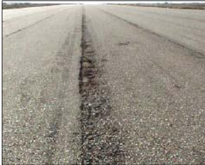
Figura 23. Fisuras longitudinales y transversales de severidad alta.
