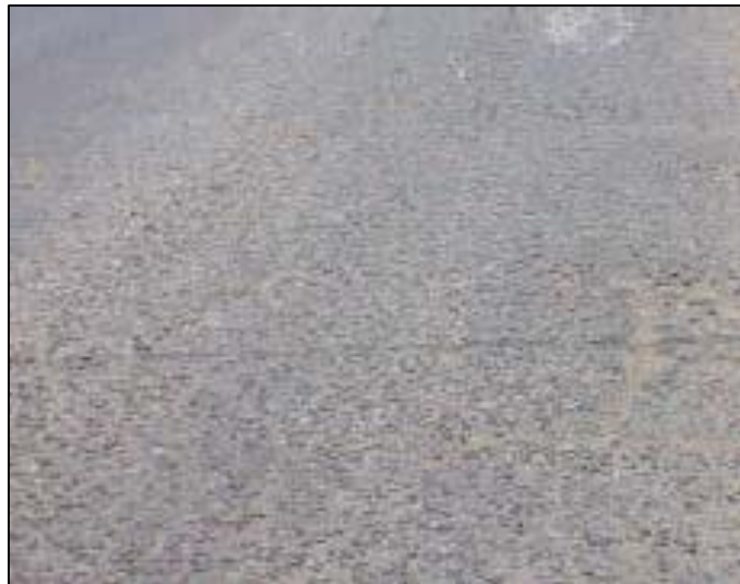
Figura 28. Peladura de severidad baja.
