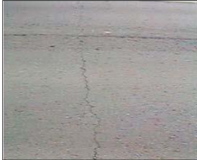
Figura 19. Reflexión de juntas de severidad baja.
