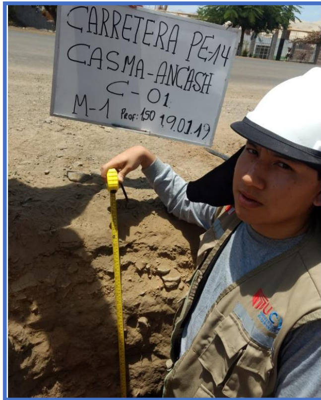
Realización de la calicata 1.00x1.00m, a 1.50m de profundidad a nivel de sub-rasante
