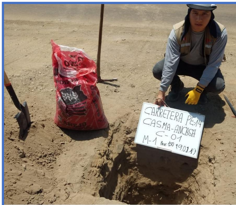
Se muestra el perfil estratigráfico que presenta la estructura del pavimento flexible en la carretera PE-14 Casma, Ancash.
