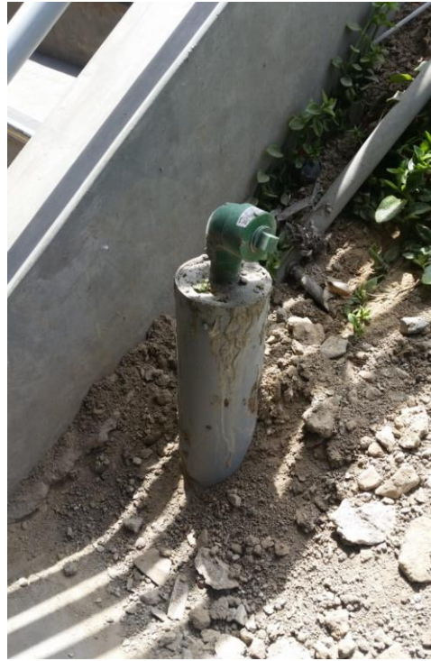
Fotografía. 10. Punto para sistema de riego. Fuente: Elaboración propia.
