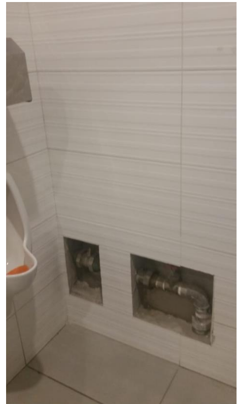
Fotografía. 18 Conexión de la red de agua tratada a los SS.HH del mall, Para los urinarios. Fuente: Elaboración propia
