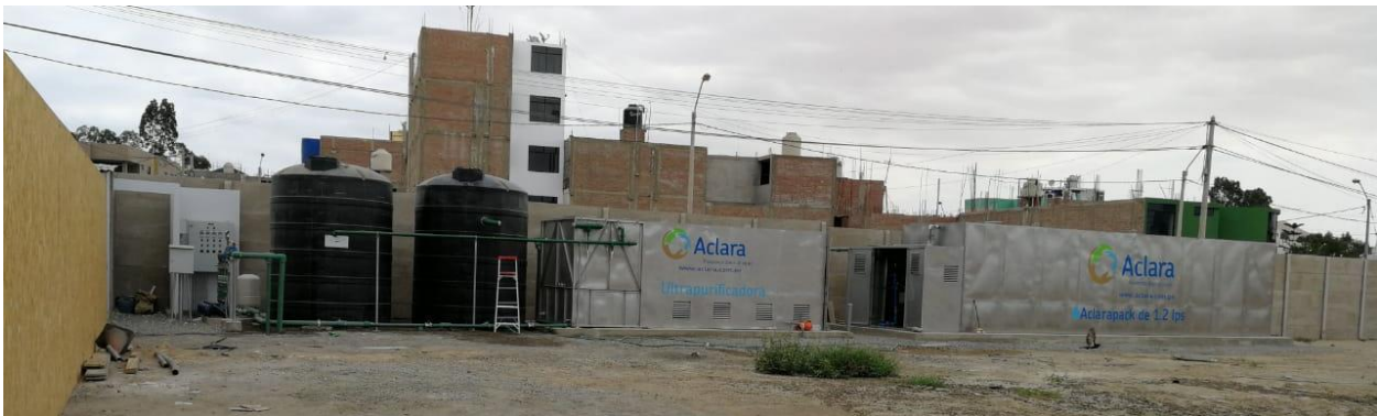
Fotografía. 2 Sistema de almacenamiento de agua tratada, implementada en el C.C. El quinde de Ica. Fuente: Elaboración propia
