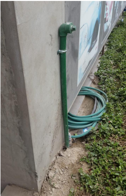
Fotografía. 12 Punto para sistema de riego en zona 5. Fuente: Elaboración propia.
