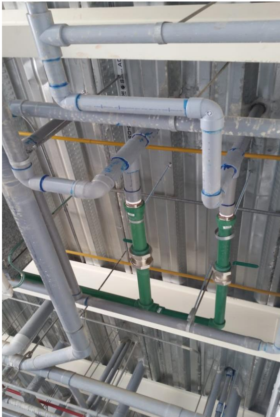
Fotografía. 15 Instalaciones de la sanitaria a las instalaciones del C.C. El Quinde de Ica. Fuente: Elaboración propia.
