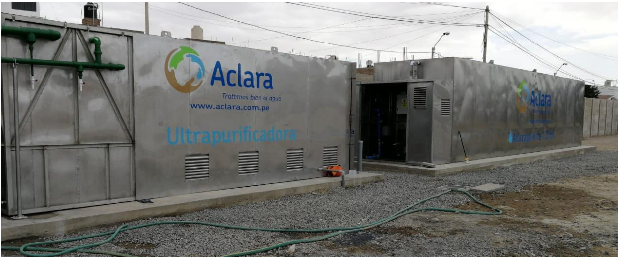
Fotografía. 1 Planta compacta de tratamiento de aguas residuales, tecnología mexicana sistema de lodos activados. Fuente: Elaboración propia.
