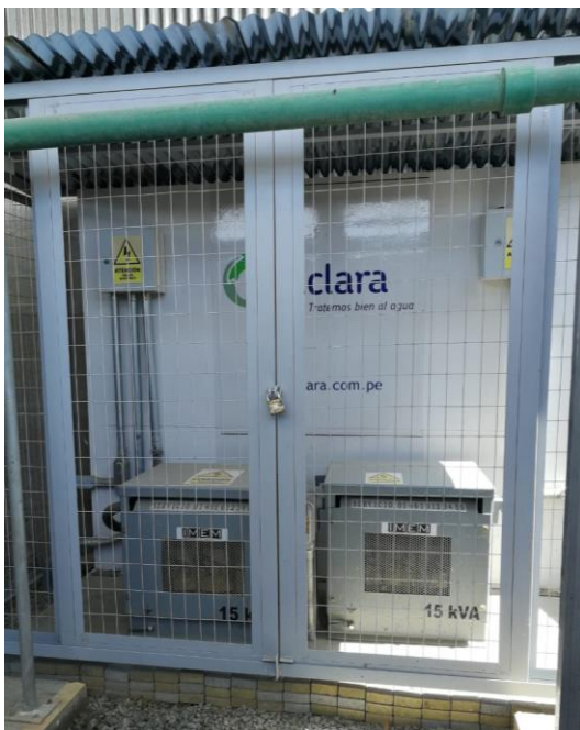
Fotografía. 2 Sistema Eléctrico de la PTAR. Fuente: Elaboración propia.
