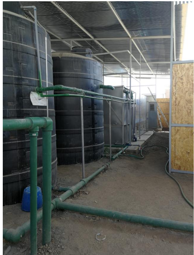
Fotografía. 14 Área de instalación de la PTAR AclaraPack. Fuente: Elaboración propia.
