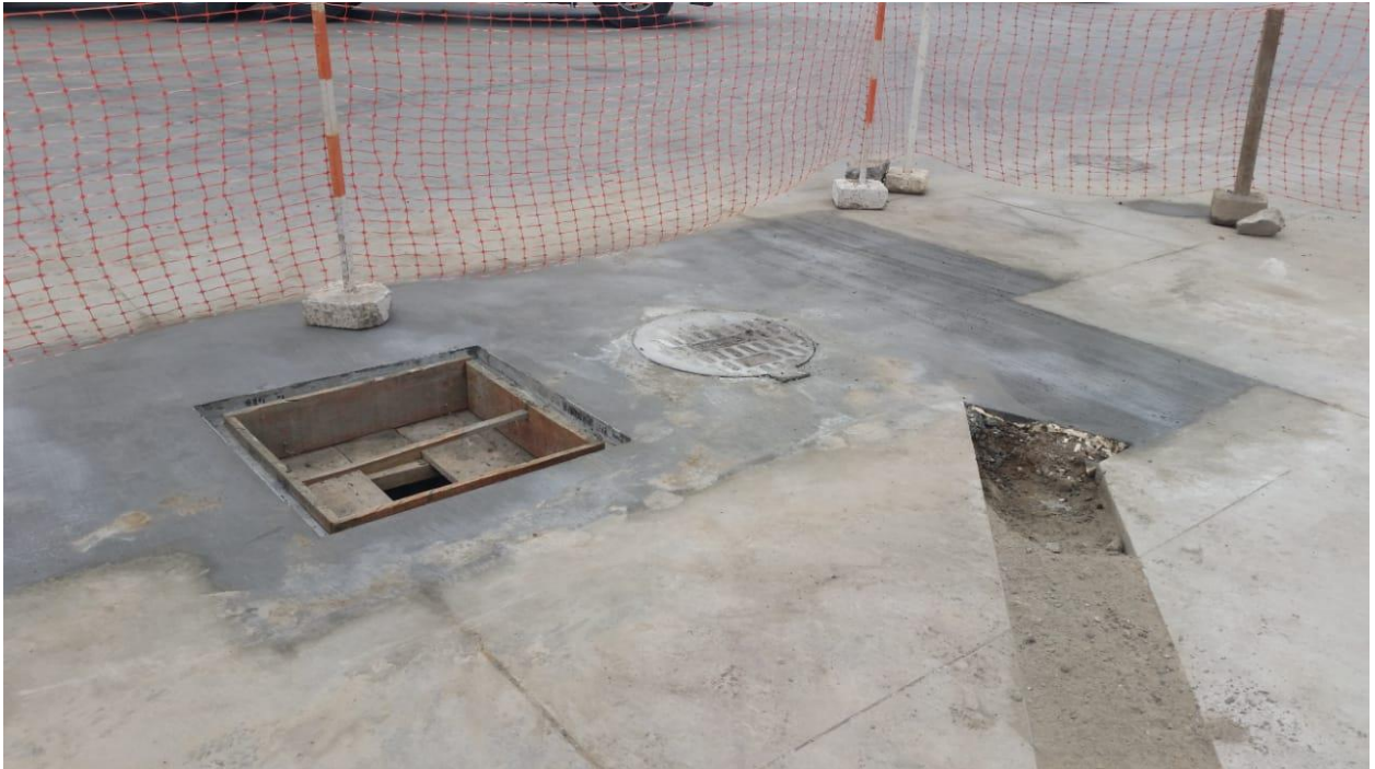
Fotografía. 13 Cámara de captación y bombeo de aguas residuales. Fuente: Elaboración propia.
