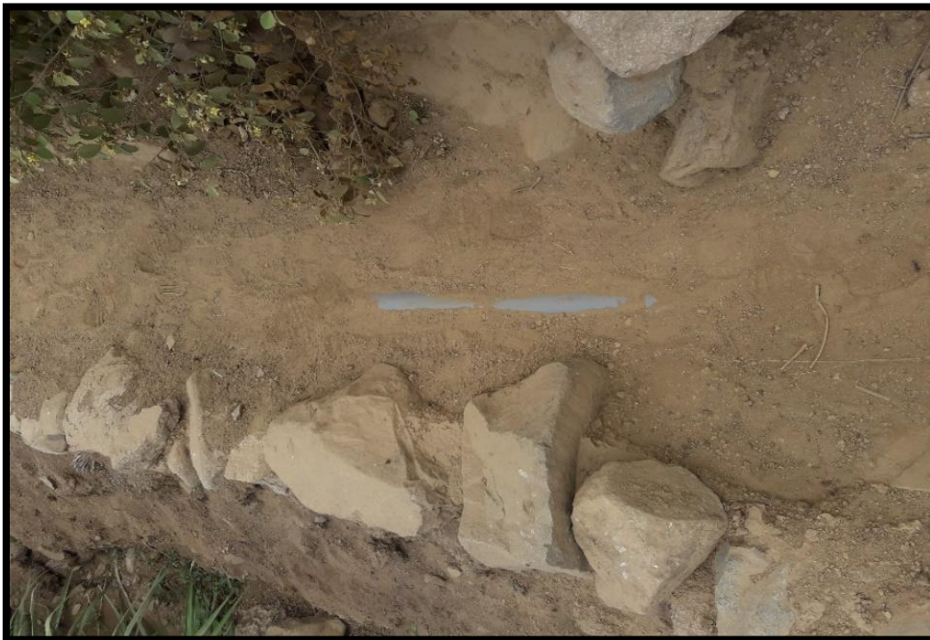
Figura 34: Tuberías expuestas en tramos peatonales.
