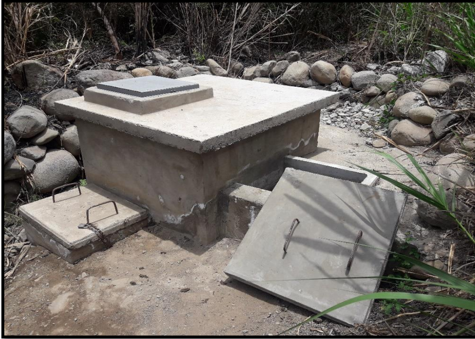
Figura 29: Captación existente: Manantial de Fondo Concentrado ubicado en el sector de Jesús María.
