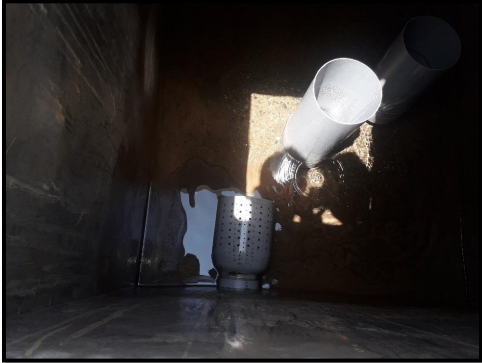
Figura 31: Captación existente: Cámara Húmeda.
