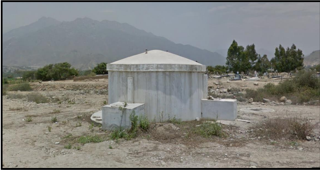
Figura 33: Reservorio de 10 m 3 deteriorados por el tiempo de vida.
