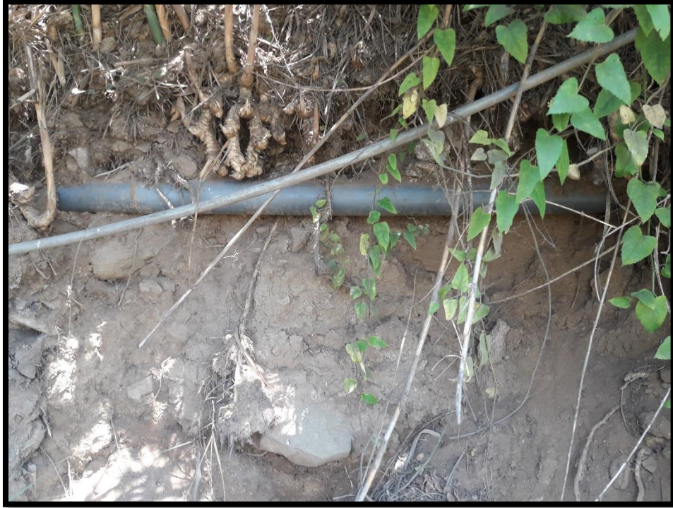
Figura 35: Tuberías expuestas a la intemperie.
