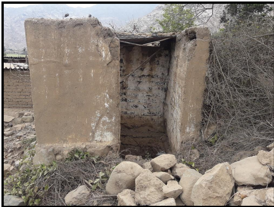
Figura 42: Sistema de Saneamiento Básico: Uso de pozos ciegos y letrinas para eliminación de excretas.
