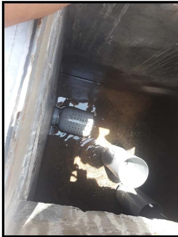
Figura 32: Canastilla y tubo de rebose de la cámara húmeda.
