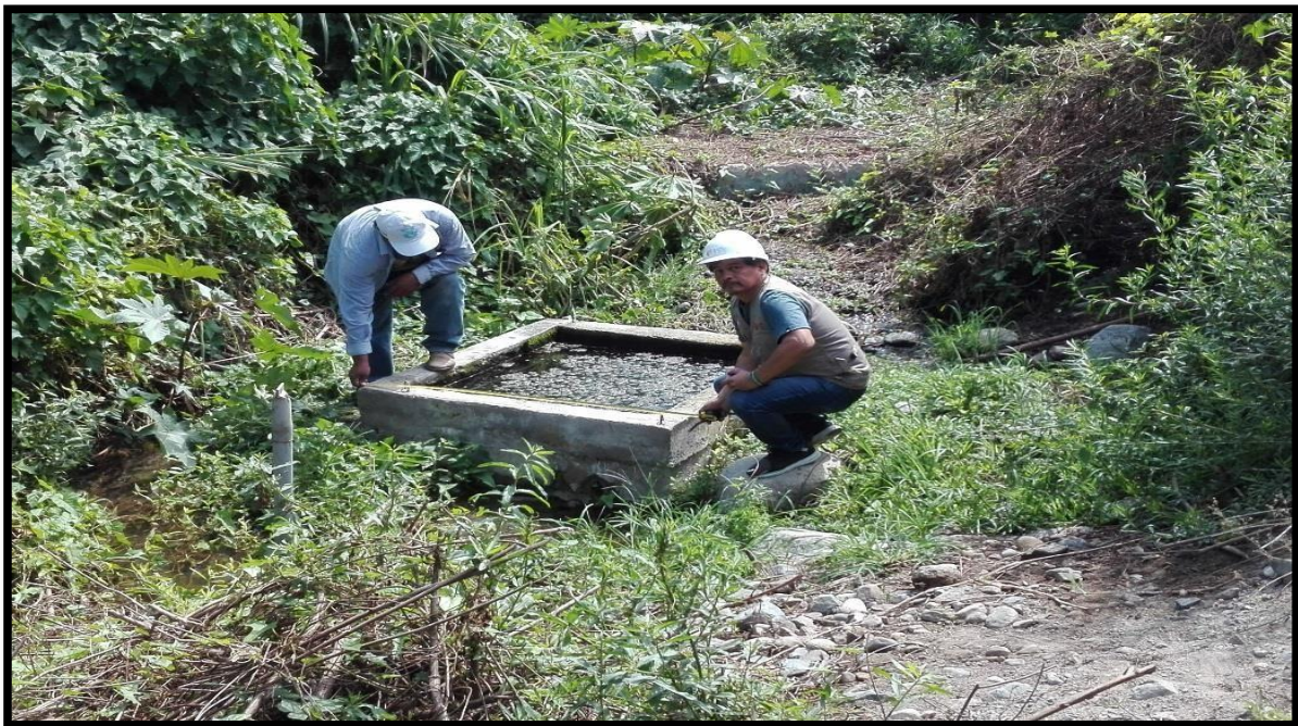
Foto N° 04 Cámara de captación existente: no cuenta con válvula de control está expuesta no tiene tapa.
