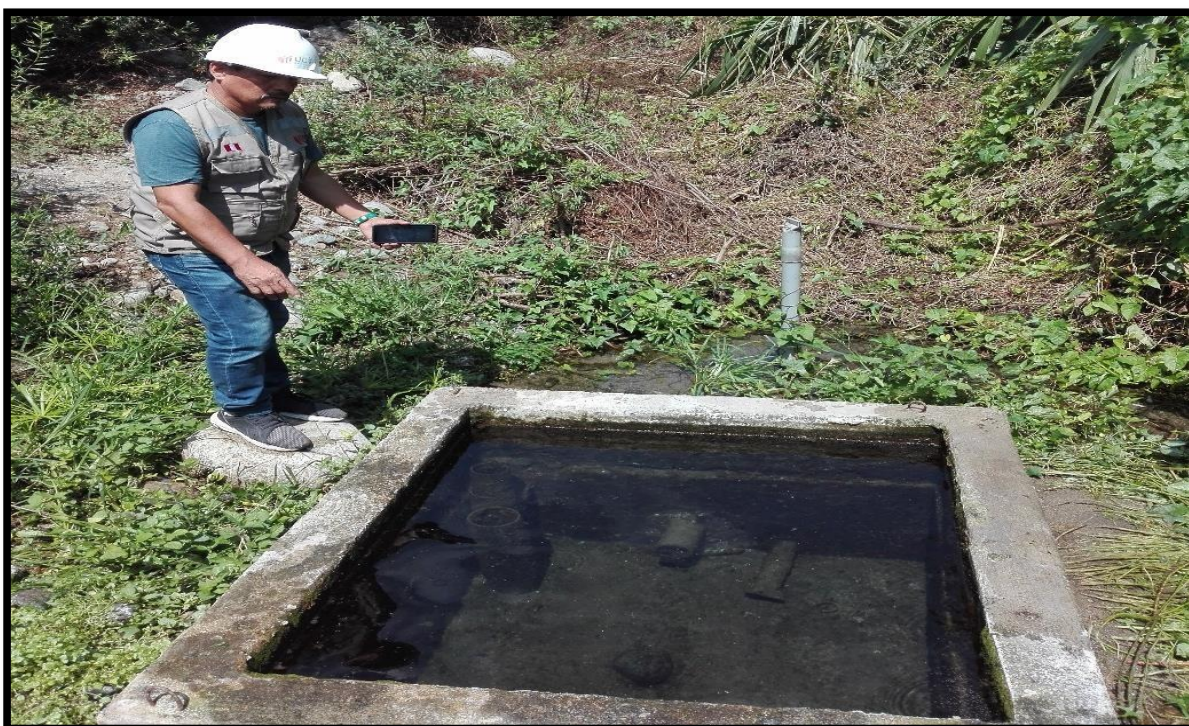
Foto N° 02 Cámara de captación existente: se observa el tubo de rebose de 4" de diámetro y el tubo de salida también de 4" de diámetro
