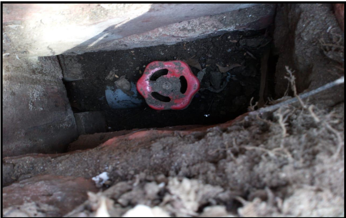
Foto N° 06 Vista de llave de distribución
