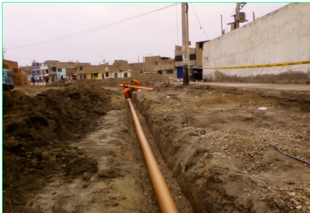
Figura 09: Vista de tendido de Tubería PVC UF 200mm en Zanja de Red de Alcantarillado con una cuadrilla de tres peones, en el Sector Cieza de León.
