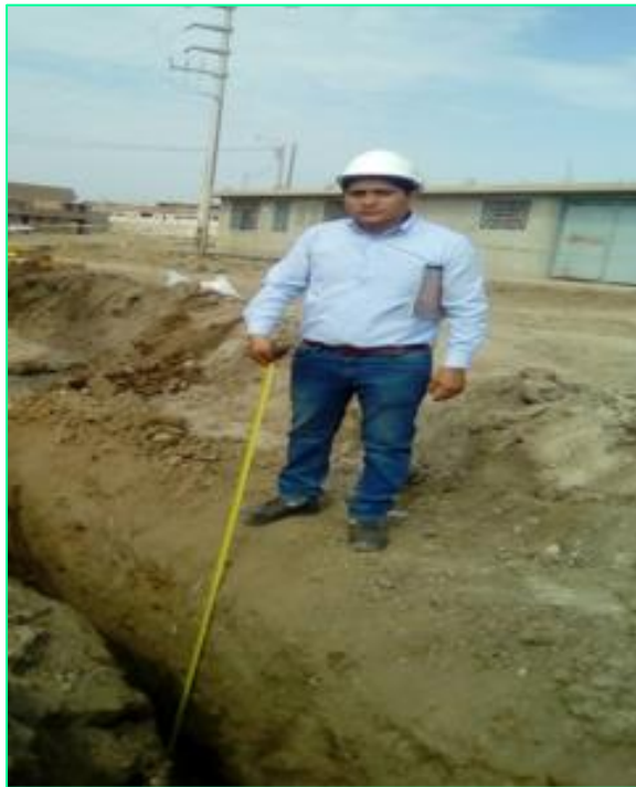
Figura 08: Vista toma de datos de los avances diarios (Metrado) para la implementación y recolección de datos según la Metodología Lean Construction.
