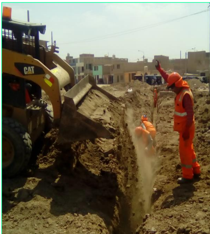
Figura 07: Vista de trabajos de colocación de cama de apoyo con ripio c/equipo d=200\text{mm} Prof. Max.=2.50m af=1.00
