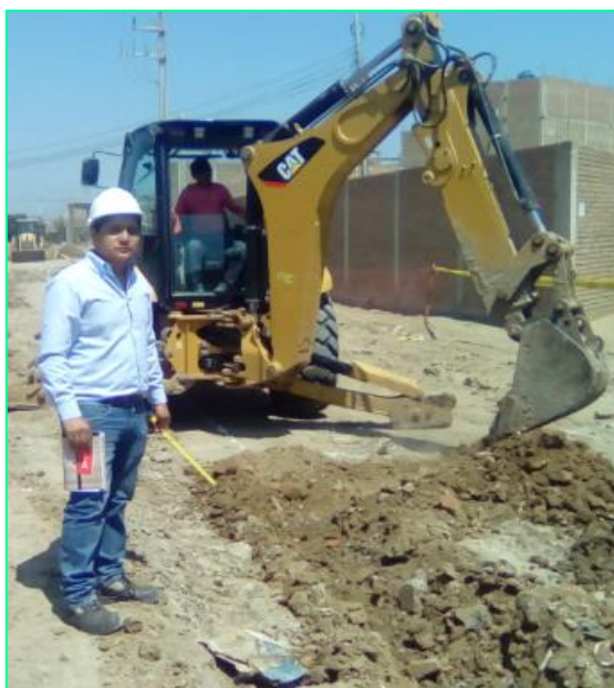
Figura 06: Toma de datos In situ de los avances diarios para es ISP Lean Construction.
