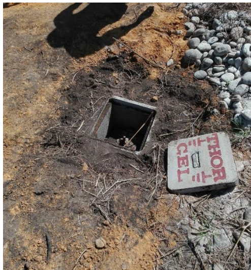
Figura 32. Puesta a tierra terminada con bentonita sódica
