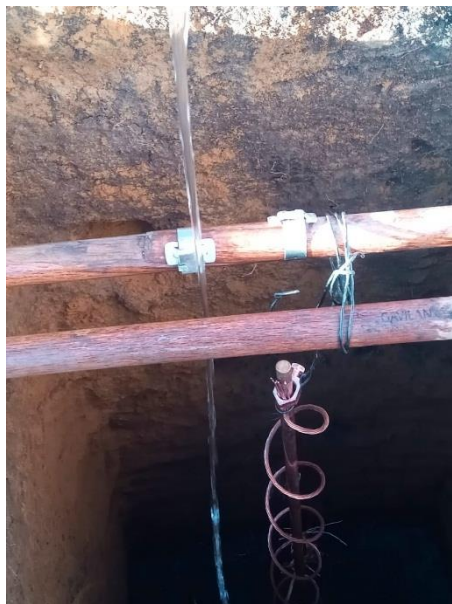
Figura 38 Varilla de bronce para este sistema de puesta a tierra
