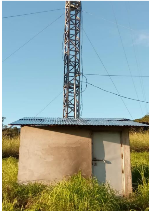
Figura 26. Estación de Telecomunicaciones Antares
