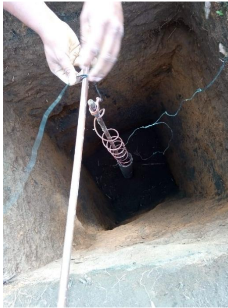
Figura 33. Varilla de coperweld para la instalación de la puesta a tierra
