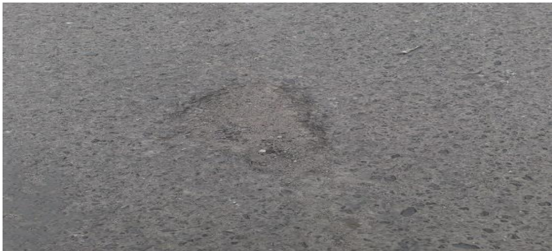
Figura 12: Desprendimiento del agregado
