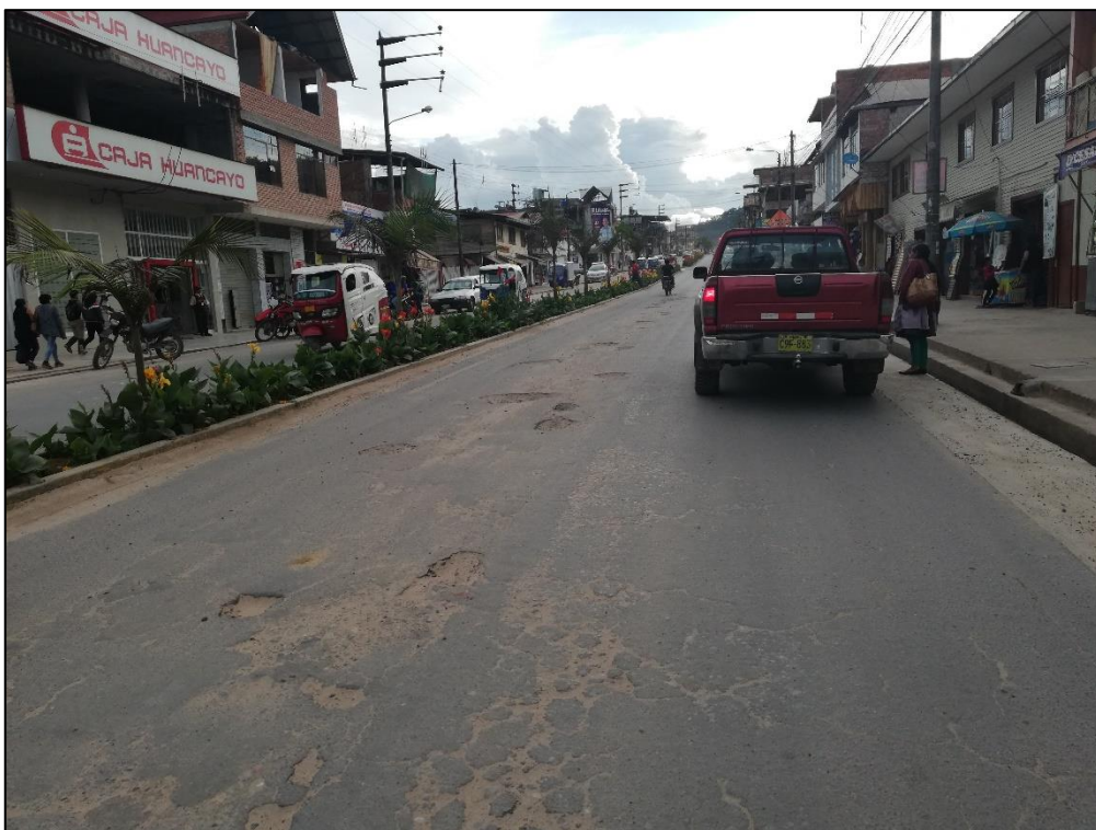
Fotografía 8. Inspección visual del pavimento flexible
