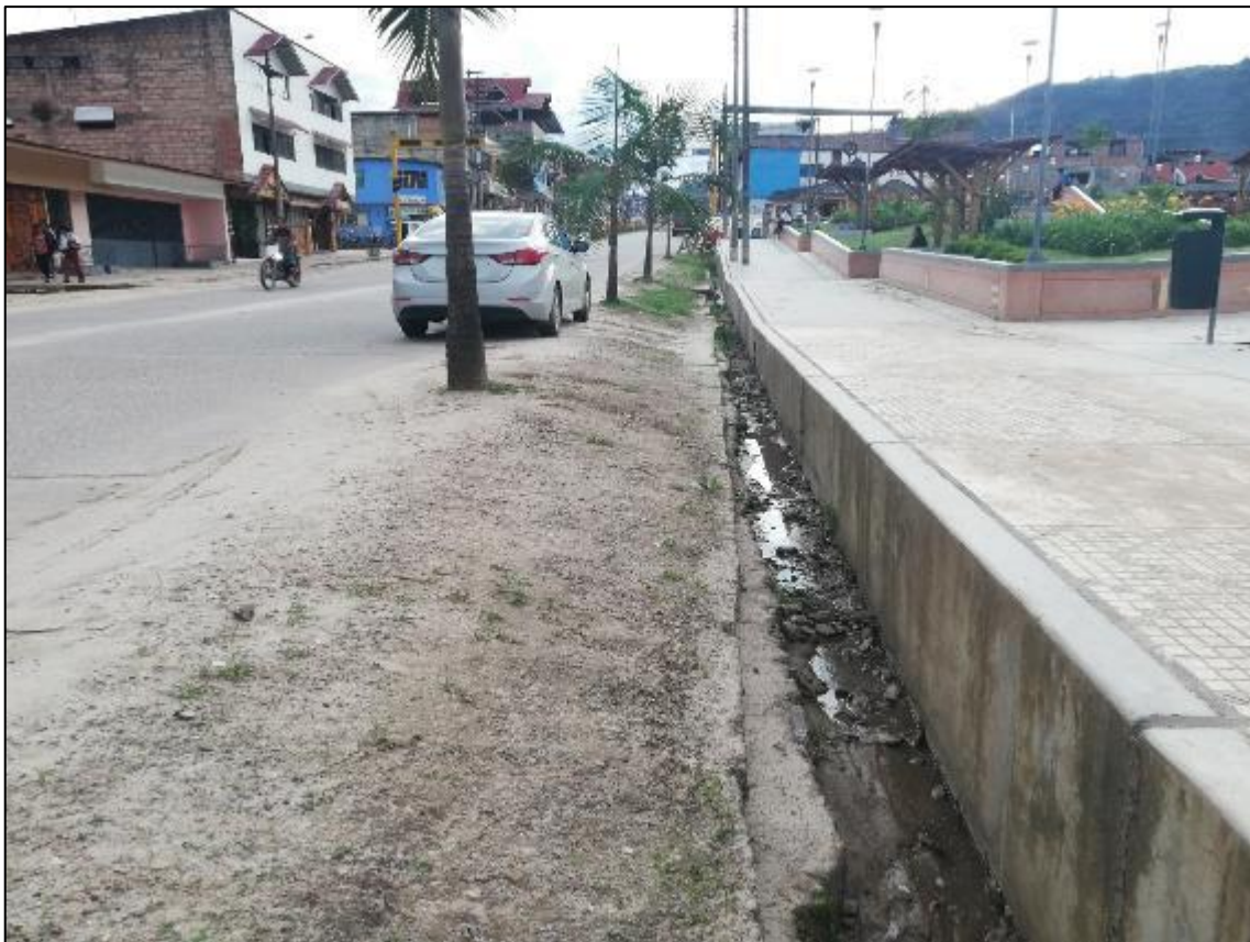
Fotografía 6. Obstrucción de cuneta
