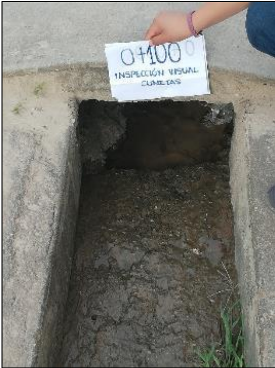
Fotografía 4. Desgaste de cuneta
