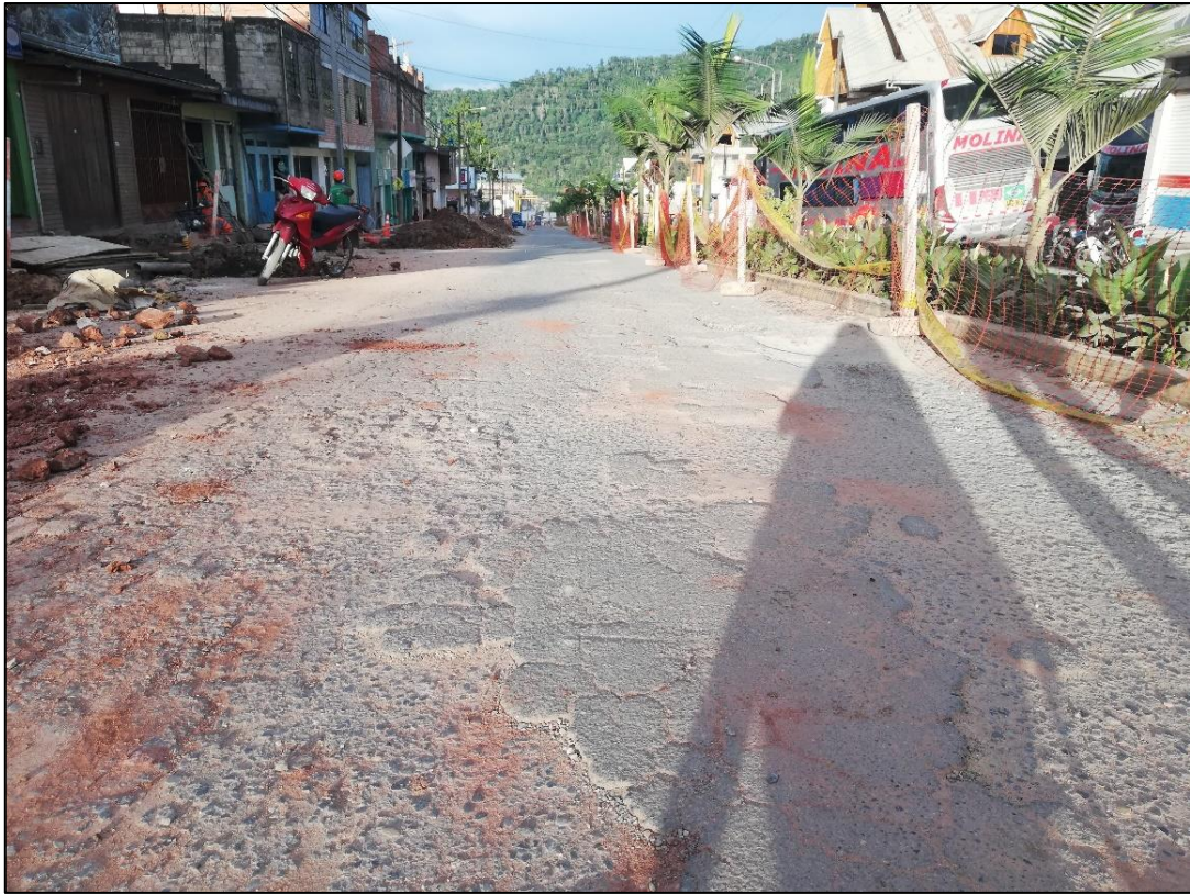
Fotografía 7. Inspección visual del pavimento flexible
