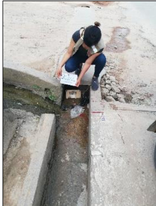
Fotografía 5. Obstrucción de cuneta
