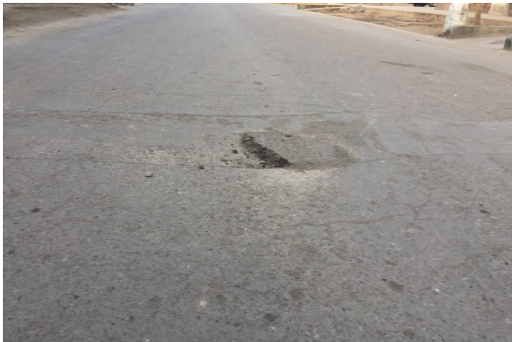
Figura 3: Evidencia de hundimiento en la calle 4
