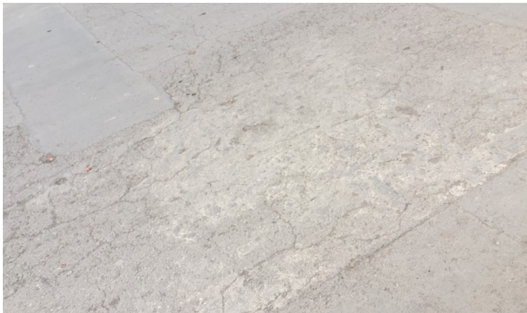
Figura 4: Evidencia de grieta de piel de cocodrilo en la calle 4
