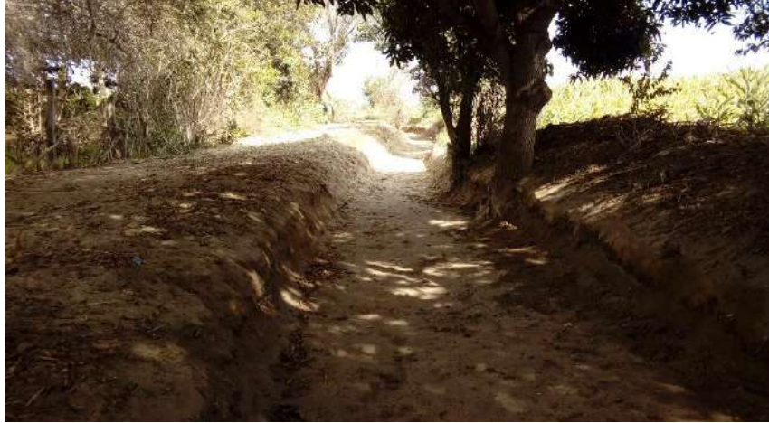
Figura 11. Se observa retención y erosión de los taludes de canal.
