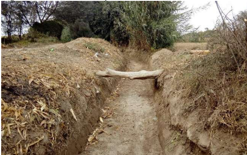
Figura 9. Se observa retención y erosión de los taludes de canal.
