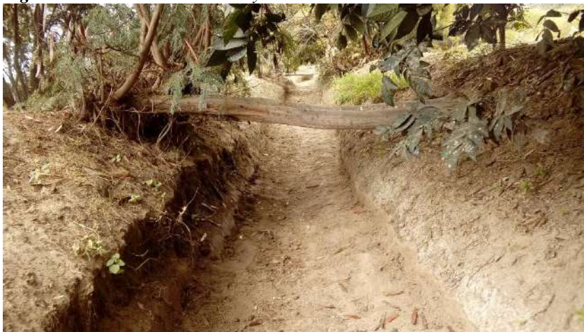
Figura 10. Se observa retención y erosión de los taludes de canal.
