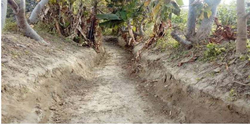
Figura 8. Se observa erosión de los taludes de canal.
