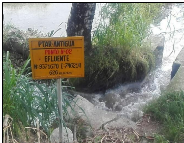
Descarga del efluente de la PTAR
