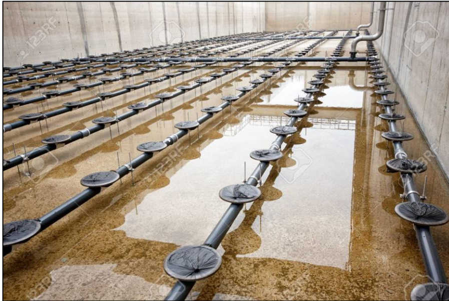
Figura 10. Tanque de aireación
