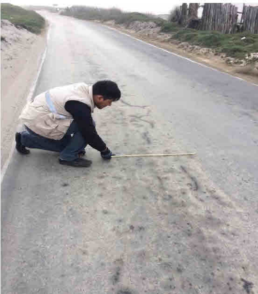
Figura 44. Medición del ancho de la exudación del asfalto encontrado de severidad M
