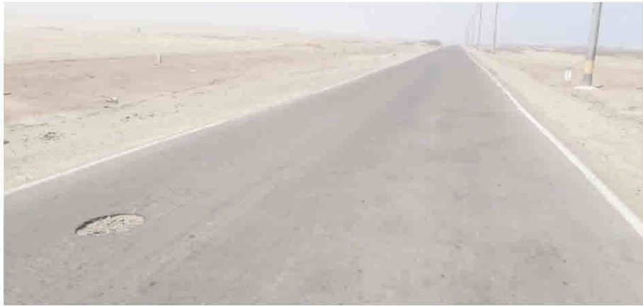
Figura 37. Unidad de inspección U – 381 ubicada entre los 12 + 920 KM – 12 + 954 KM de la carretera Huanchaco – Santiago de Cao
