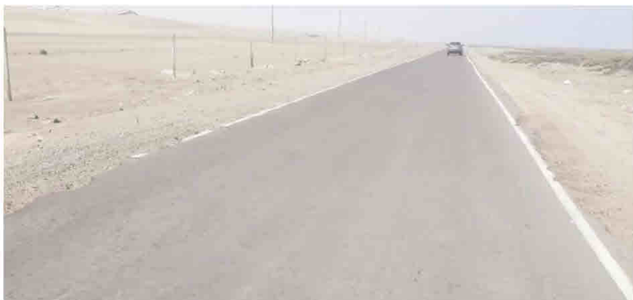
Figura 36. Unidad de inspección U – 347 ubicada entre los 11 + 764 KM – 11 + 798 KM de la carretera Huanchaco – Santiago de Cao
