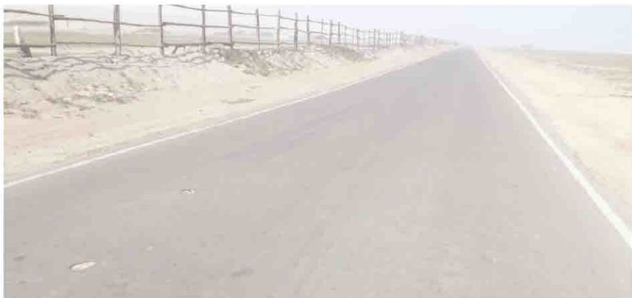
Figura 33. Unidad de inspección U – 245 ubicada entre los 8 + 296 KM – 8 + 330 KM de la carretera Huanchaco – Santiago de Cao
