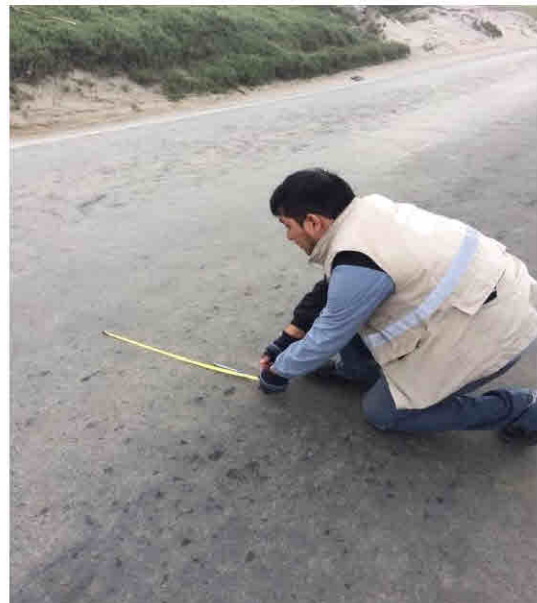
Figura 45. Medición del ancho de la exudación del asfalto encontrado de severidad L
