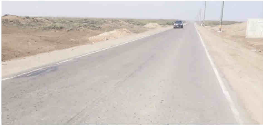
Figura 40. Unidad de inspección U – 483 ubicada entre los 16 + 388 KM – 16 + 422 KM de la carretera Huanchaco – Santiago de Cao
