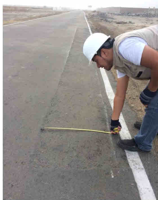
Figura 47. Medición de la longitud del bache y/o zanja reparada encontrado de severidad L.
