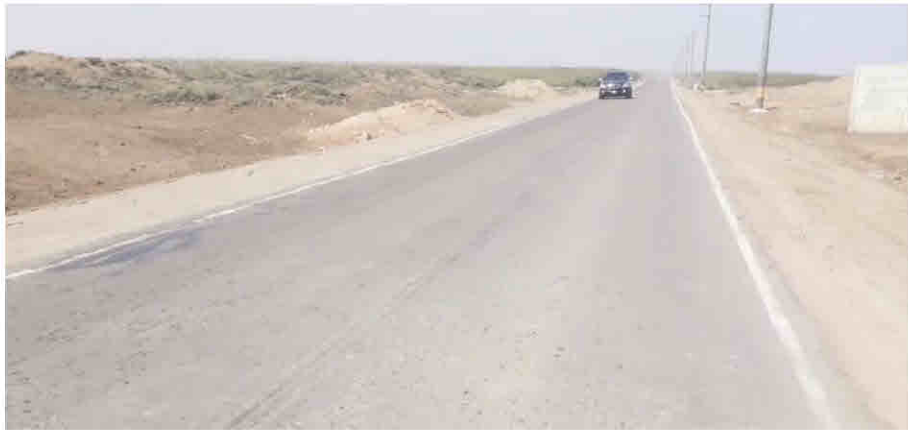
Figura 41. Unidad de inspección U – 517 ubicada entre los 17 + 544 KM – 17 + 578 KM de la carretera Huanchaco – Santiago de Cao
