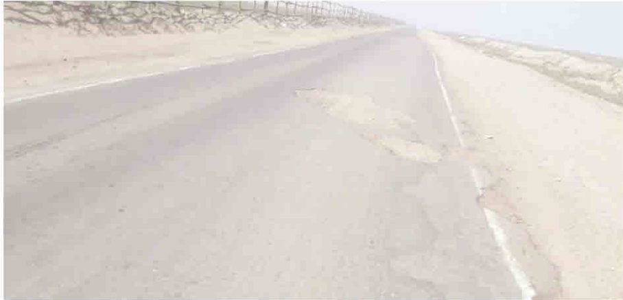
Figura 34. Unidad de inspección U – 279 ubicada entre los 9 + 452 KM – 9 + 486 KM de la carretera Huanchaco – Santiago de Cao
