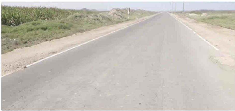
Figura 39. Unidad de inspección U – 449 ubicada entre los 15 + 232 KM – 15 + 266 KM de la carretera Huanchaco – Santiago de Cao
