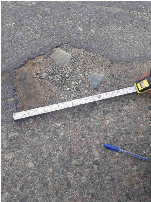
Figura 42. Medición de la longitud del hueco encontrado de severidad L
