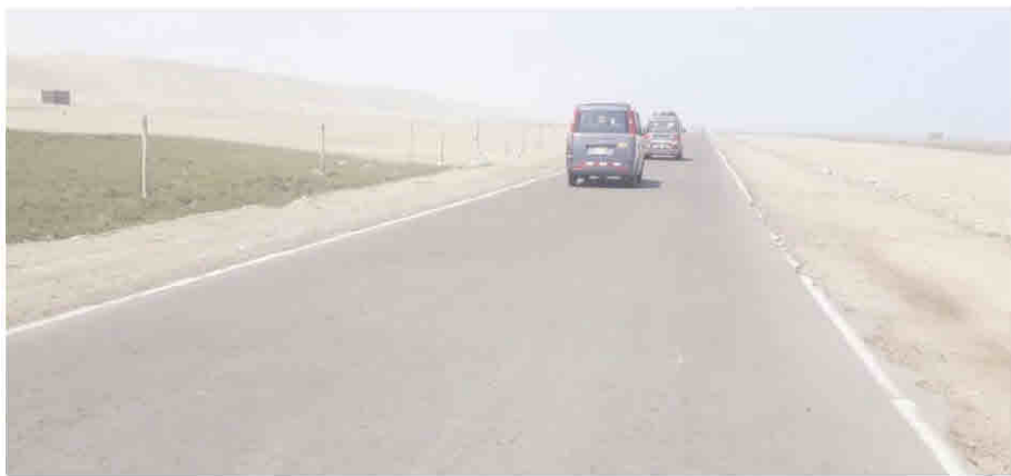
Figura 35. Unidad de inspección U – 313 ubicada entre los 10 + 608 KM – 10 + 642 KM de la carretera Huanchaco – Santiago de Cao
