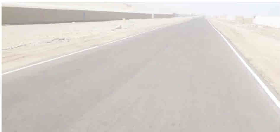
Figura 30. Unidad de inspección U – 143 ubicada entre los 4 + 828 KM – 4 + 862 KM de la carretera Huanchaco – Santiago de Cao
