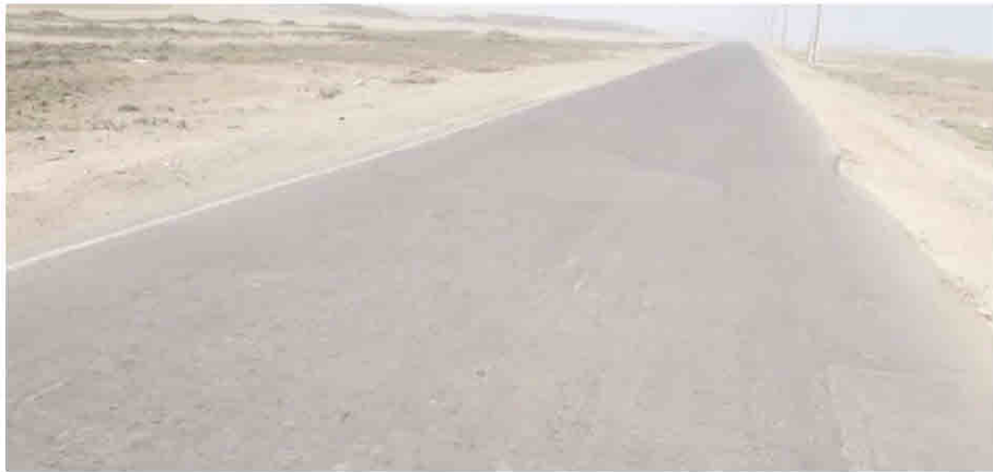
Figura 38. Unidad de inspección U – 381 ubicada entre los 14 + 076 KM – 14 + 110 KM de la carretera Huanchaco – Santiago de Cao
