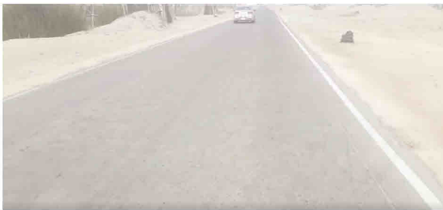
Figura 26. Unidad de inspección U – 007 ubicada entre los 0 + 204 KM – 0 + 238 KM de la carretera Huanchaco – Santiago de Cao
