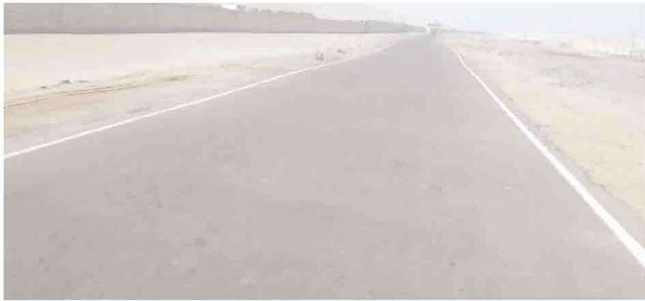
Figura 29. Unidad de inspección U – 109 ubicada entre los 3 + 672 KM – 3 + 706 KM de la carretera Huanchaco – Santiago de Cao
