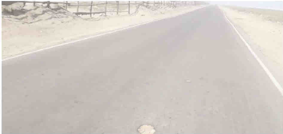
Figura 32. Unidad de inspección U – 211 ubicada entre los 7 + 140 KM – 7 + 174 KM de la carretera Huanchaco – Santiago de Cao
