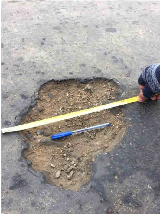
Figura 46. Medición de la longitud del hueco encontrado de severidad L.
