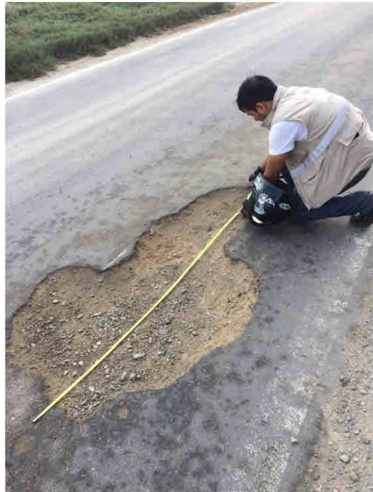
Figura 43. Medición de la longitud del hueco encontrado de severidad H
