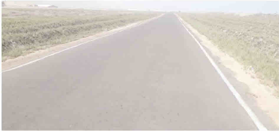
Figura 31. Unidad de inspección U – 177 ubicada entre los 5 + 984 KM – 6 + 018 KM de la carretera Huanchaco – Santiago de Cao
