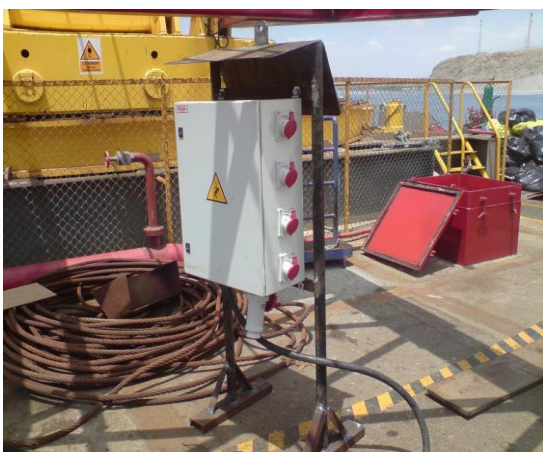
La instalación eléctrica realizada en la barcaza San Fernando para la empresa COOPTIMEP II.
