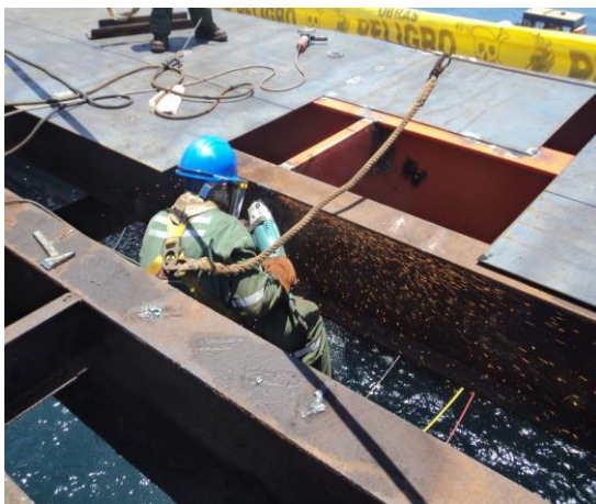
Se está utilizando el EPP el correcto (arnés, línea de vida, casco y protección para las vistas).
