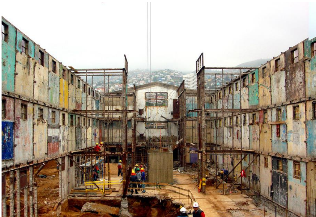
Figura 37. Proceso de restauración de la ex – cárcel de Valparaíso. Recuperado de: https://www.archdaily.pe/pe/02-206232/parque-cultural-valparaiso-hlps
