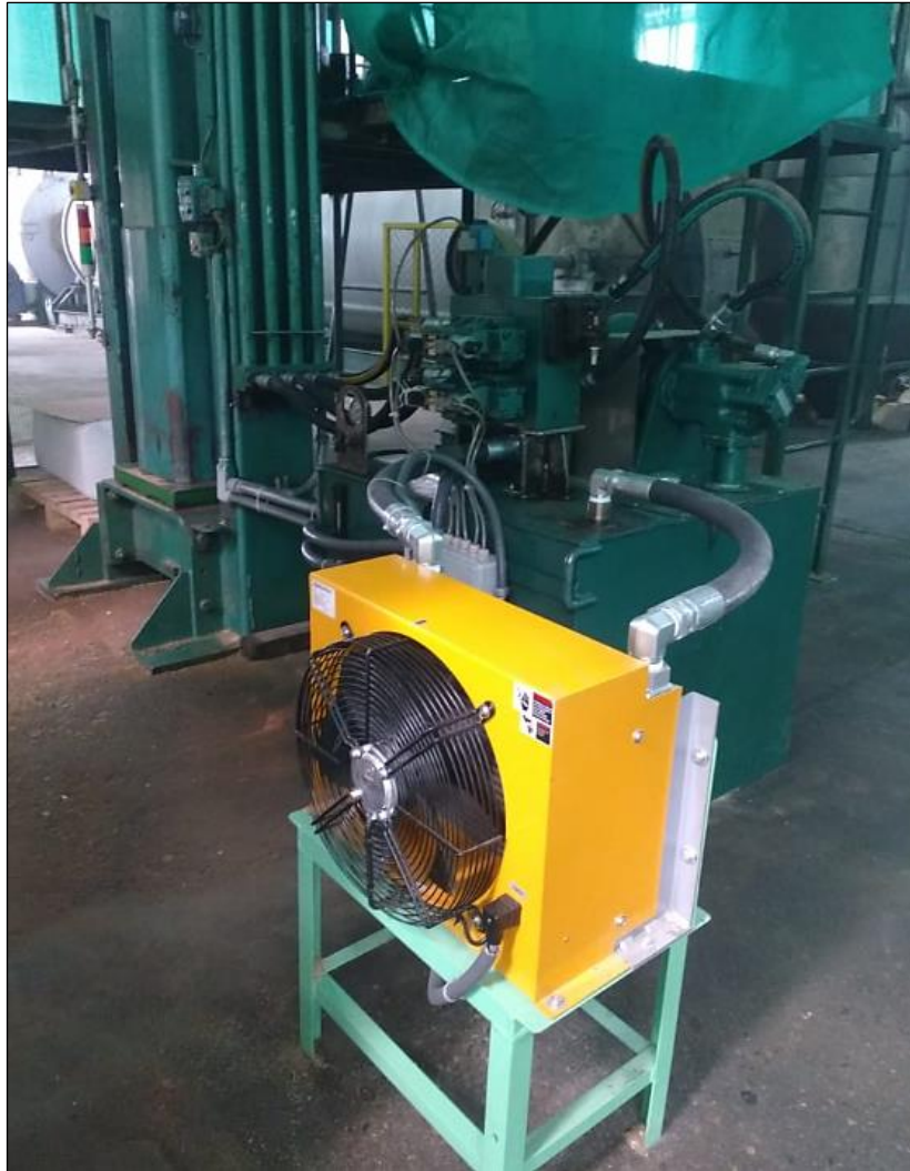
Figura 15: Intercambiador de calor instalado en la prensa hidráulica en Cítricos Peruanos S.A.
