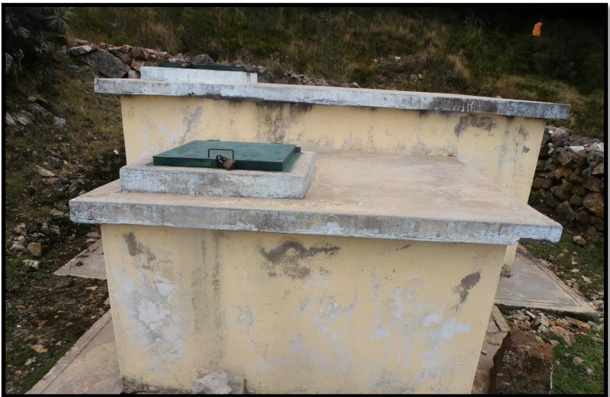
Imagen 04: Reservorio en mal estado
