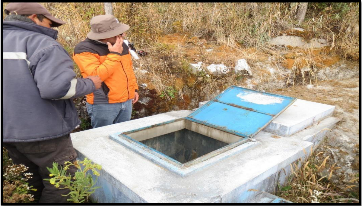
Imagen 05: Cámara rompe presión en mal estado
