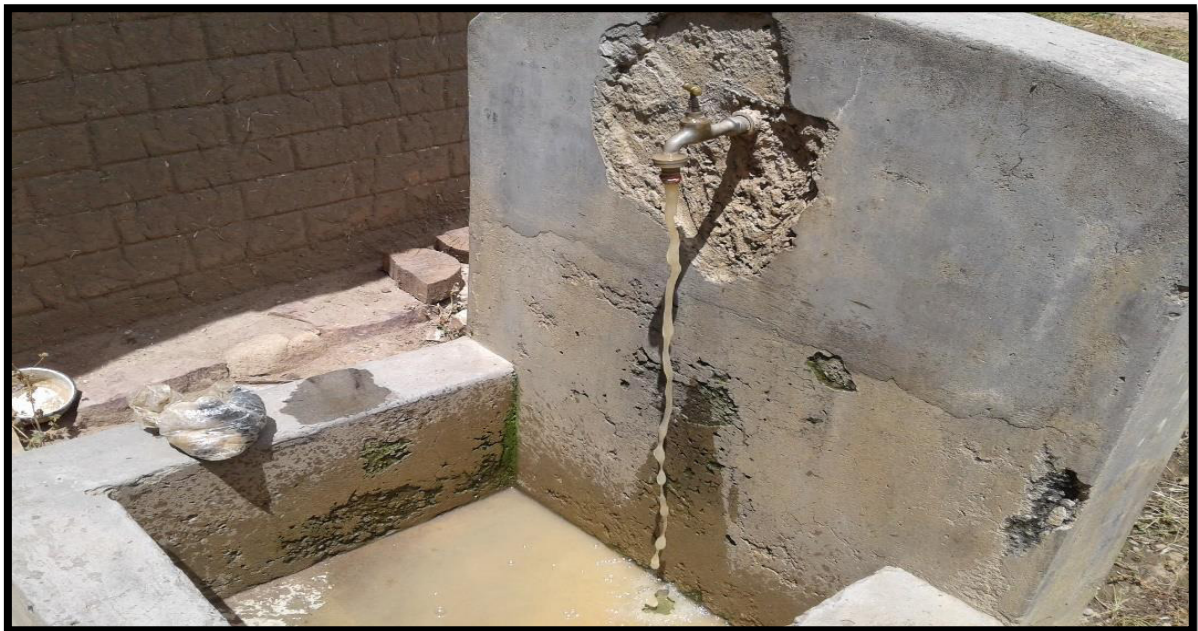
Imagen 08: Pileta en mal estado
