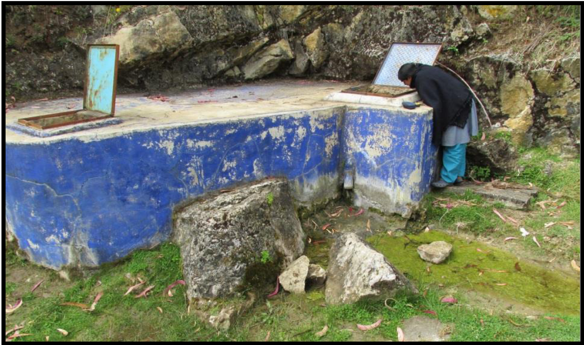
Imagen 03: Captación en mal estado
