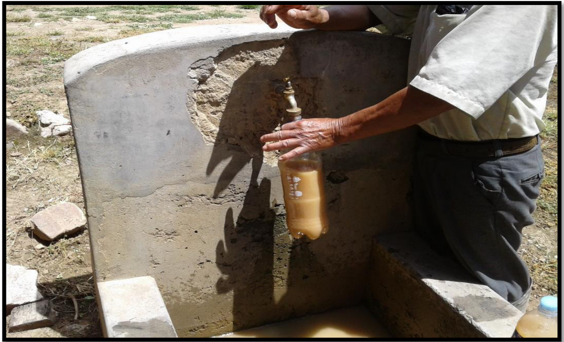
Imagen 09: Pileta con agua contaminada
