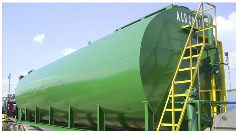
Figura 1. Tanque cilíndrico horizontal.
