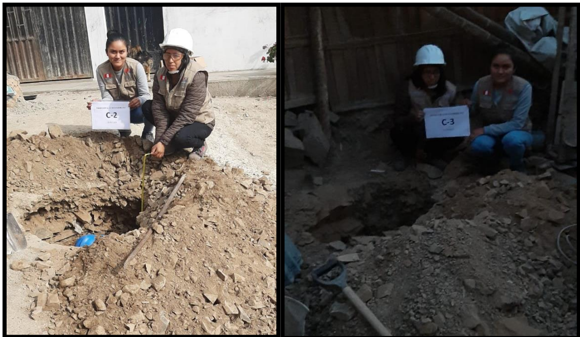
Figura 10. Extracción de las muestras de calicatas para la clasificación del suelo. Fuente: elaboración propia.
