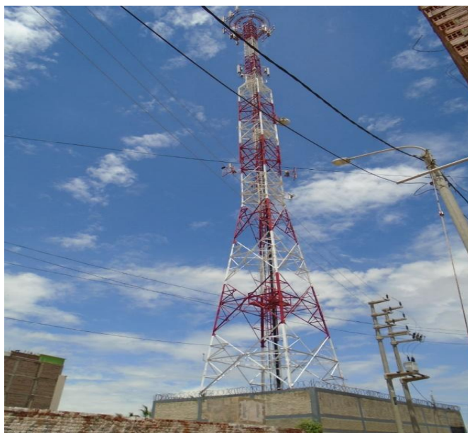
Figura I-1: Torres de telecomunicaciones en el distrito de Pimentel – Lambayeque.
