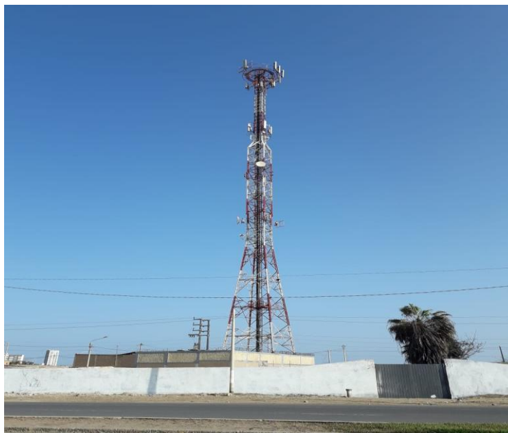
Figura I-2: Torre autoportada de telecomunicaciones “LA_Pimentel” – Chiclayo.
