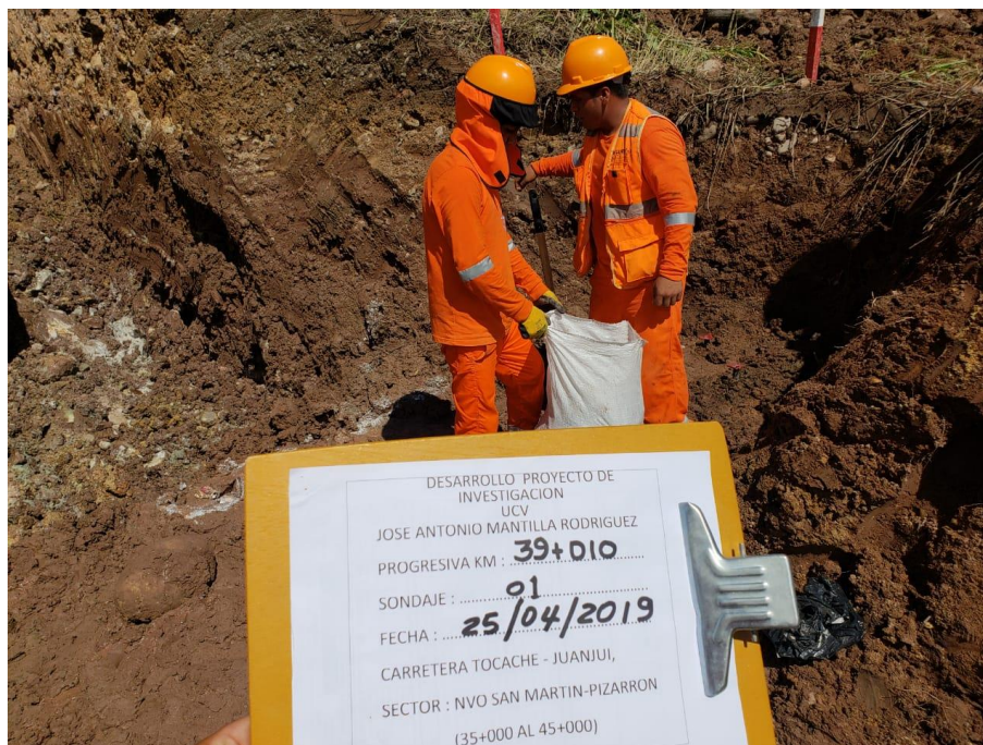
Ilustración 19 Material escavado de la sub rasante en el km 39+010 de la carretera Tocache – Juanjui.
