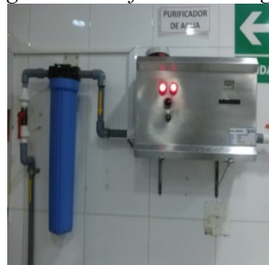
Figura 23 Purificadora de agua
