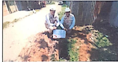
SE OBSERVA CALICATA EXCAVADA N° 04 (Jr. LIBERTAD CDRA. 10) Y PERFIL ESTRATIGRAFICO DEL TERRENO
