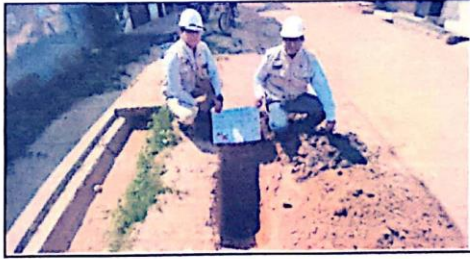
SE OBSERVA CALICATA EXCAVADA N° 01 (JR. LIBERTAD CDRA. 02) Y PERFIL ESTRATIGRAFICO DEL TERRENO
