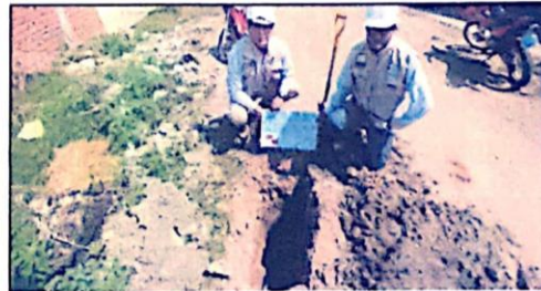
SE OBSERVA CALICATA EXCAVADA N° 02 (JR. LIBERTAD CDRA. 04) Y PERFIL ESTRATIGRÁFICO DEL TERRENO
