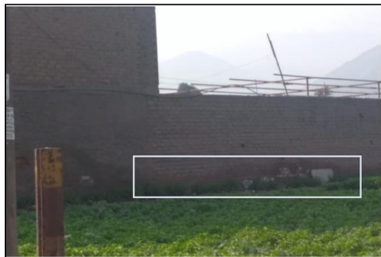
Fuente: propia (presencia de eflorescencia)
